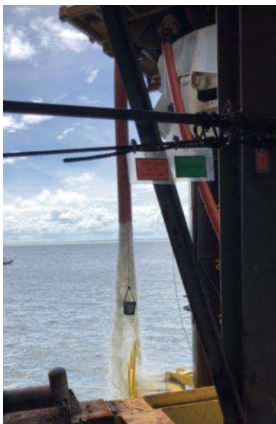
Figura 69: Perfuratriz Wirth durante escavação para estaca e “balde” para coleta de sedimentos do fundo.
