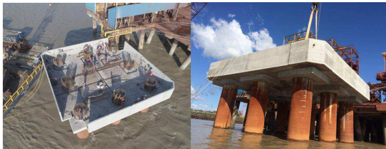
Figura 77: Montagem da armação da plataforma e vista das pré-lajes apoiadas nos capitéis
