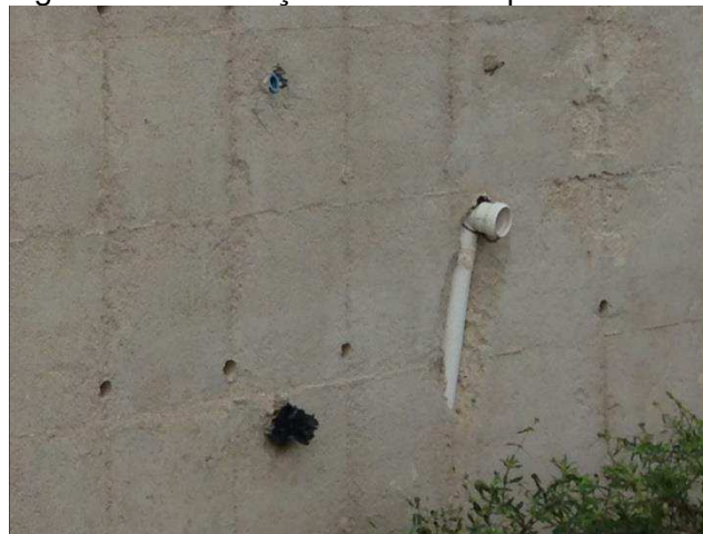
Figura 21 - Tubulação sanitária exposta
