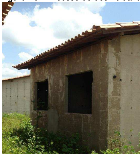
Figura 20 - Excesso de desmoldante na parede externa.
