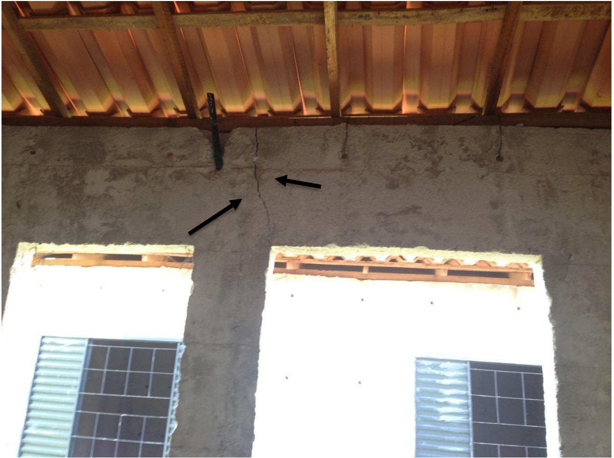
Figura 27 - Rachadura no vértice dos vãos.
