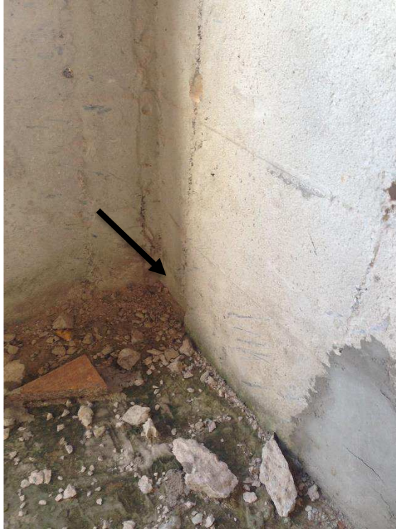
Figura 28 - Deformação ocasionada pelo deslocamento da placa
