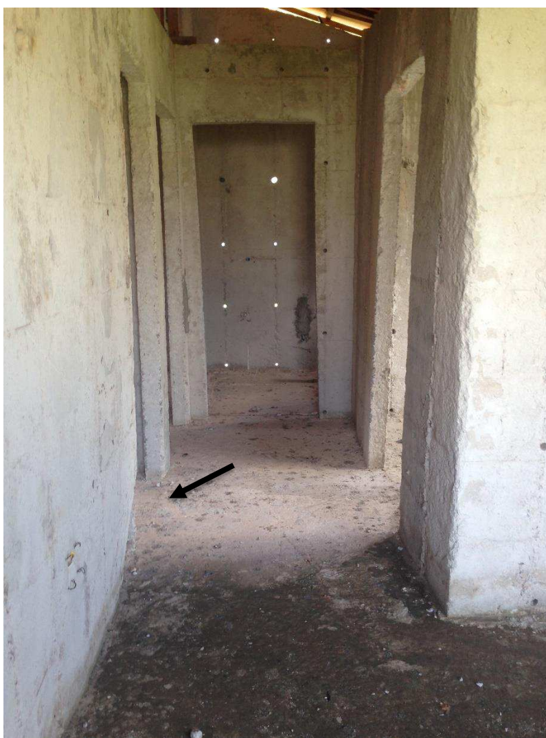
Figura 23 - Parede com abaulamento
