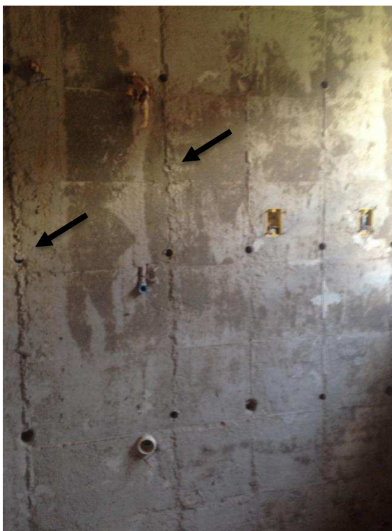
Figura 15 - Marcas de desforma
