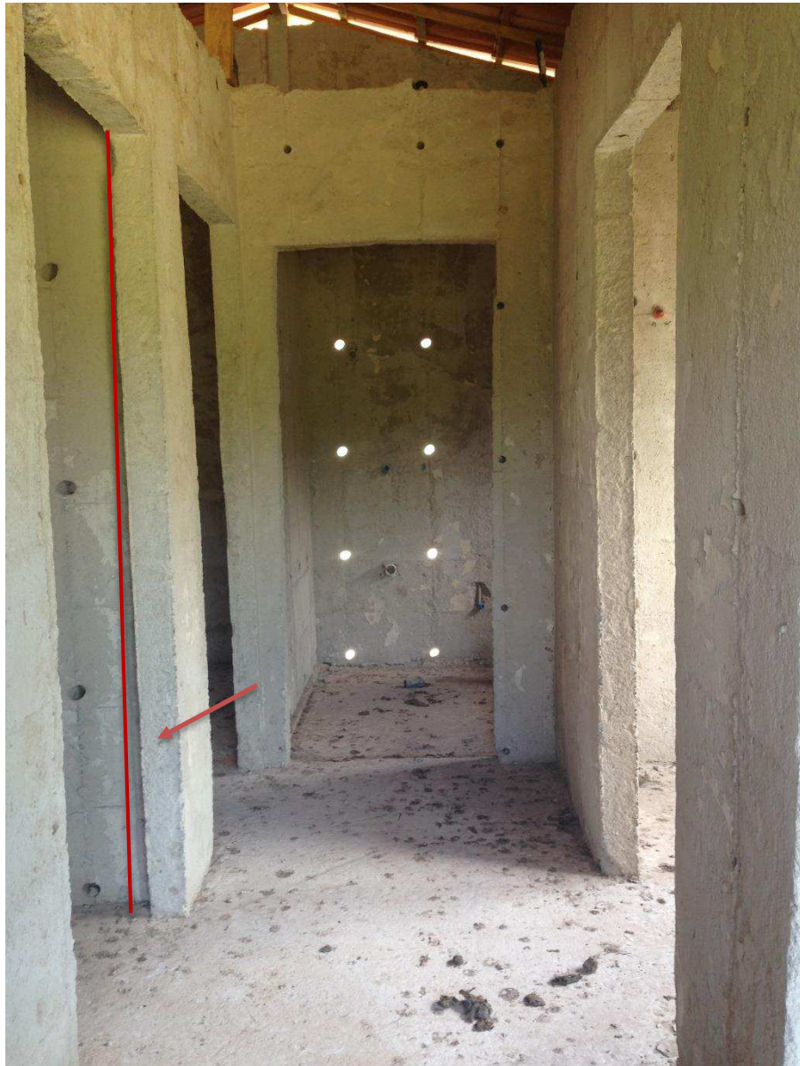
Figura 25 - Paredes fora do prumo.
