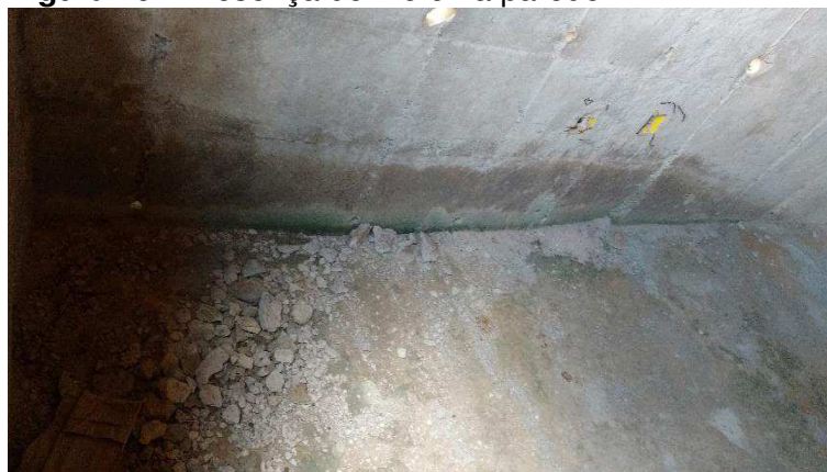
Figura 29 - Presença de mofo na parede.
