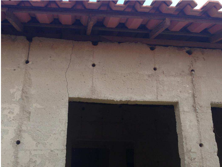
Figura 26 - Trinca nos vértices dos vãos.
