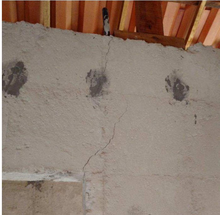
Figura 16 - Fissura no vértice do vão da porta
