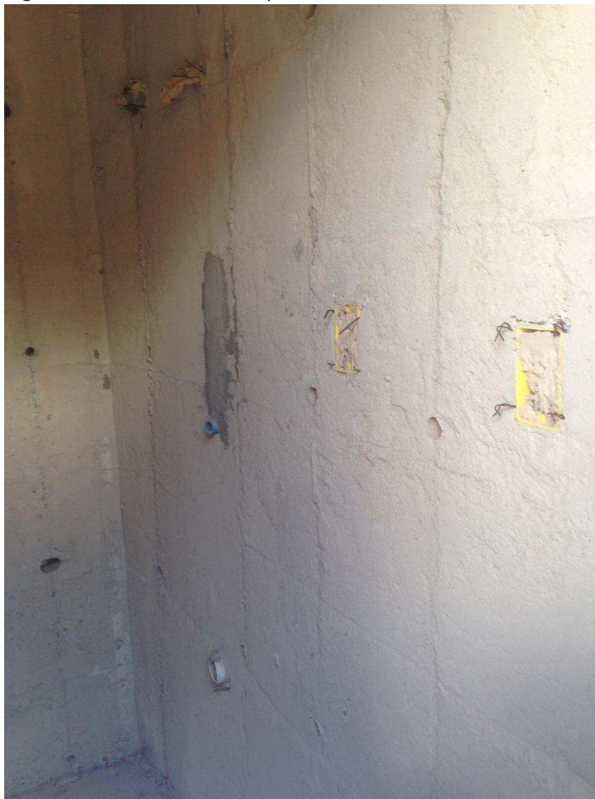
Figura 24 - Caixas de interruptores obstruídas.
