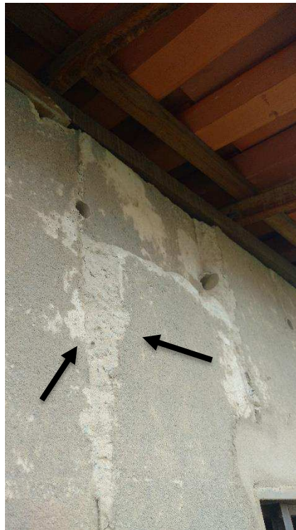
Figura 18 - Segregação do concreto
