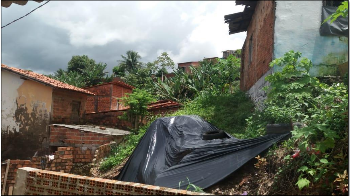
Figura 9 - Lona protegendo a encosta na Rua da Mangueira - Coroadinho
