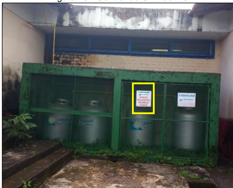
Figura 29 - Central de GLP do RU
