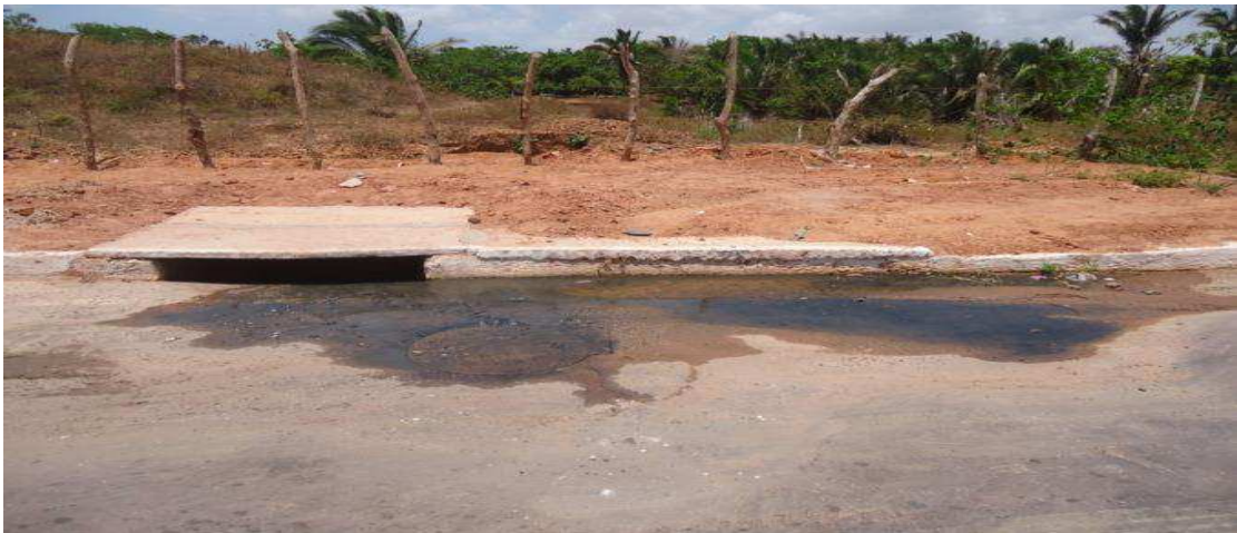
Figura 10: Esgoto jogado direto no rio/APA do Maracanã
