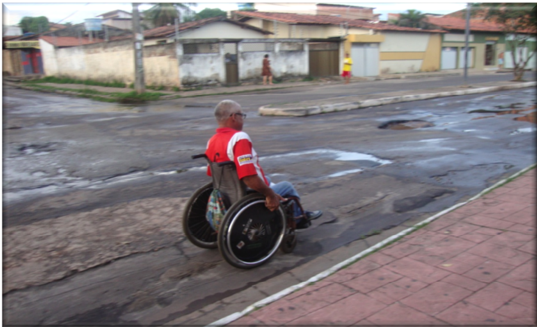
Foto 29: Barreira arquitetônica/calçada sem rebaixamento/Angelim. Fonte: CUNHA, H.W.A.P, 2010.
