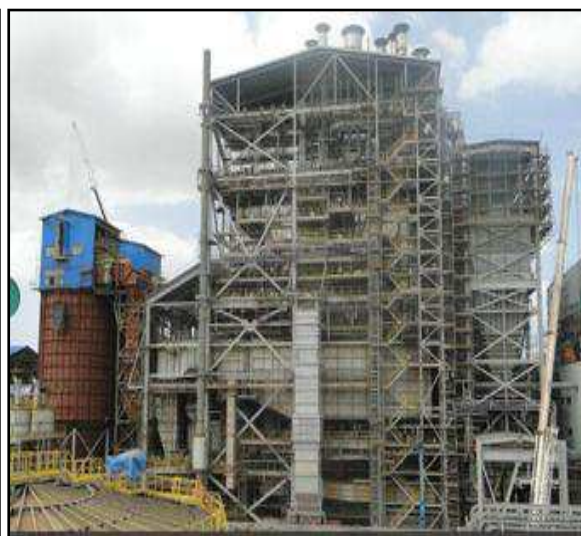
Figura 03: Prédio da turbina e caldeira da UTE
