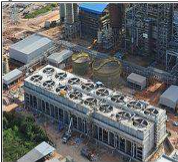
Figura 06: Torre de resfriamento da UTE
