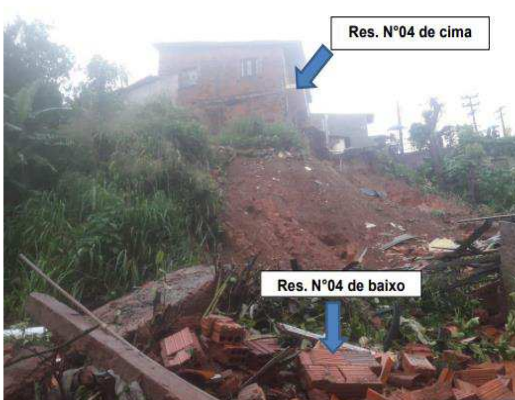
Figura 14 Deslizamento de casas no bairro Sacavém
