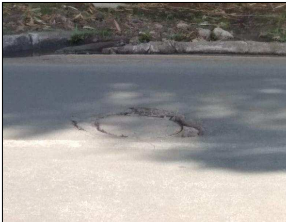
Figura 51: Poço de Visita - PV-01
