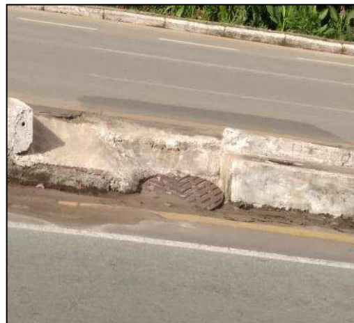
Figura 55: Poço de Visita - PV-05
