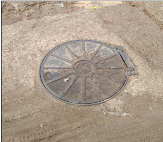
Figura 54: Poço de Visita - PV-04
