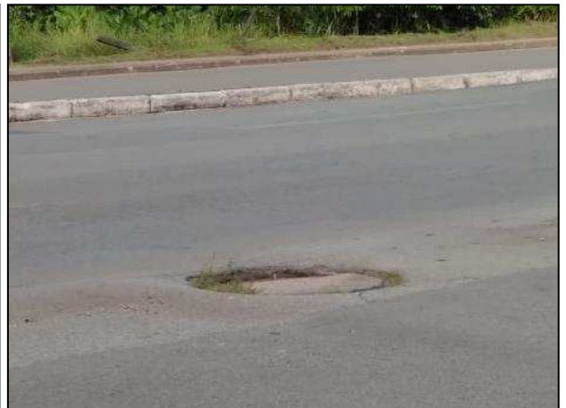
Figura 52: Poço de Visita - PV-02
