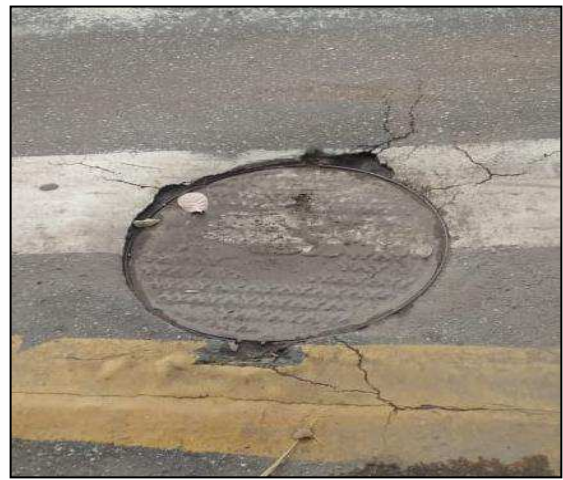
Figura 53: Poço de Visita – PV-03
