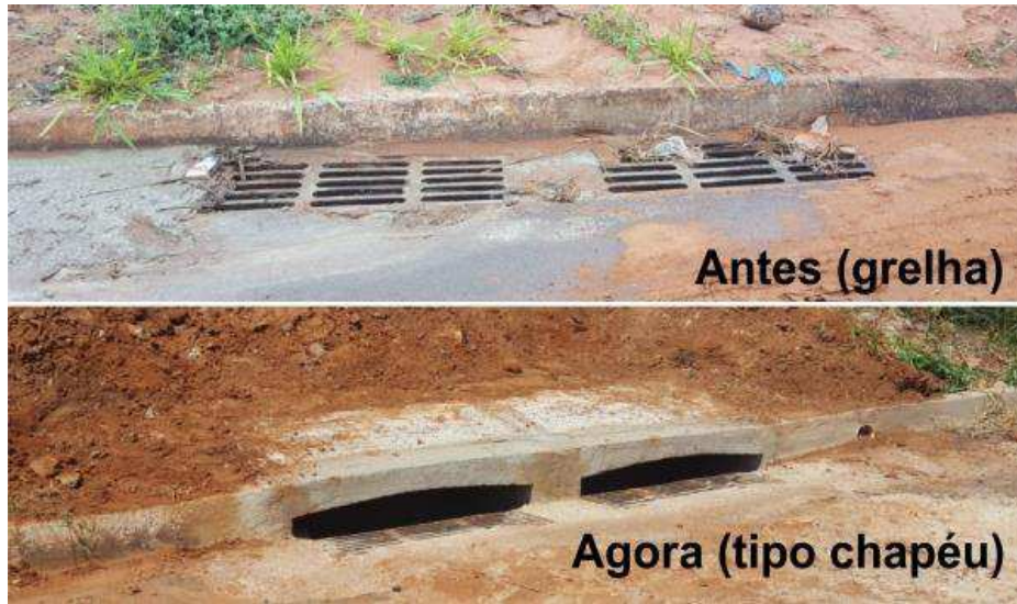
Figura 10: Boca de lobo dupla tipo grelha e guia chapéu
