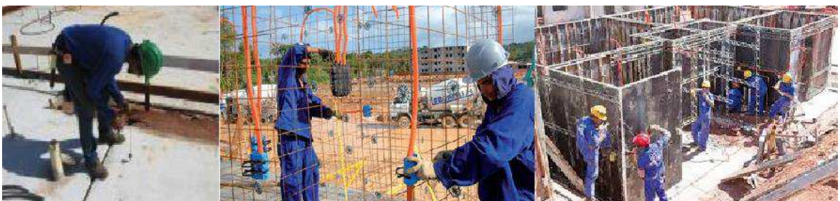
Figura 9 – Etapas de Marcação de Linhas das Paredes, Montagem de Armaduras e Instalações, Posicionamento dos Painéis de Fôrma
