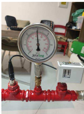
Figura 24 – Sistema em funcionamento
