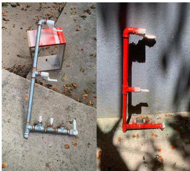
Figura 8 – Cavalete de bomba
