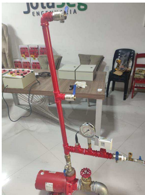
Figura 9 – Sistema de bombas
