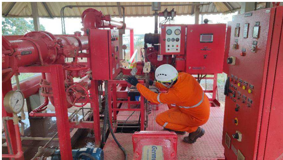
Figura 2- Sistema fixo de combate a incêndio
