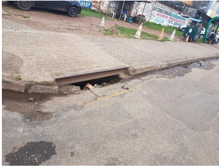
Figura 23 - Boca de lobo danificada
