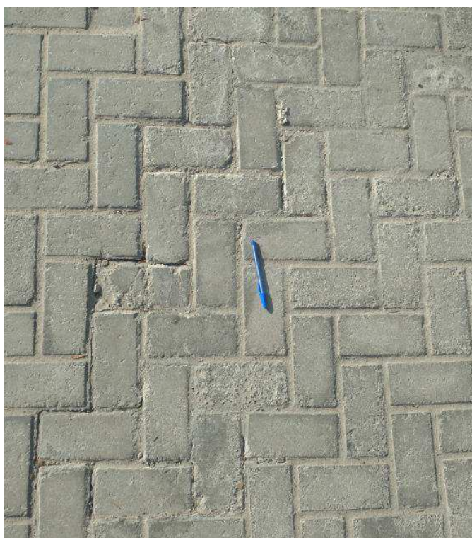
Figura 55 – Pavimento com desgaste superficial
