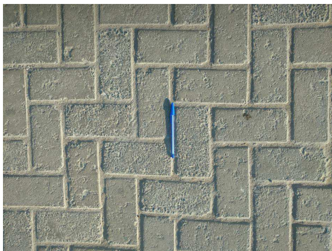
Figura 56 - Pavimento com desgaste superficial – juntas preenchidas com argamassa
