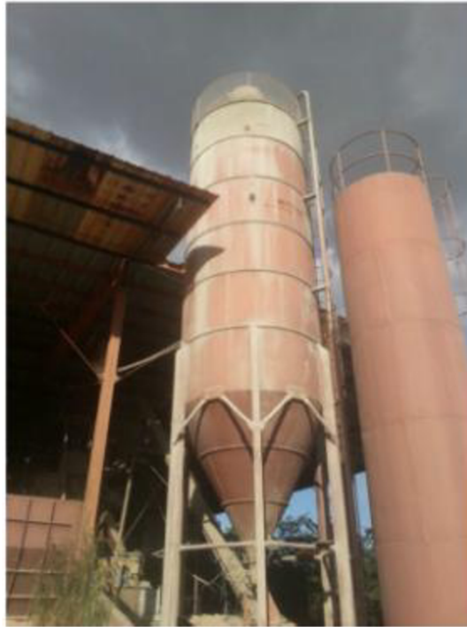
Figura 14 - Silo de armazenamento de cimento à granel
