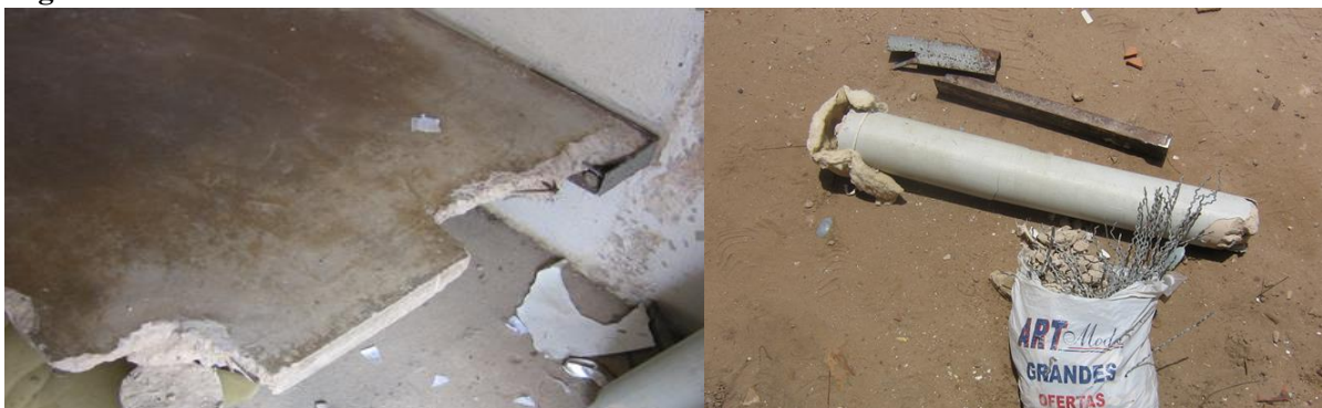
Figura 10 – Cama de concreto avariada
