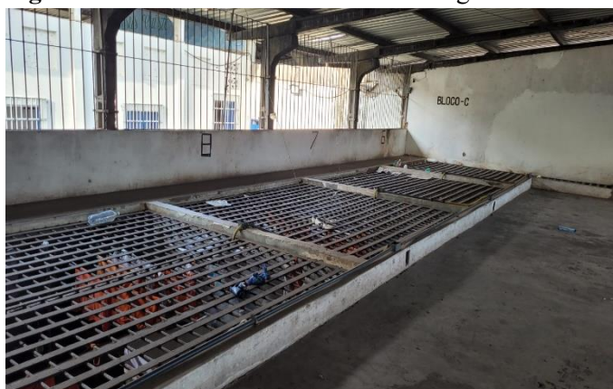
Figura 32 – UPSL 2 e 3 – teto da cela era grade
