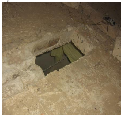
Figura 11 – Laje de uma cela do Pavilhão da UPSL 4 avariada pela ação do preso
