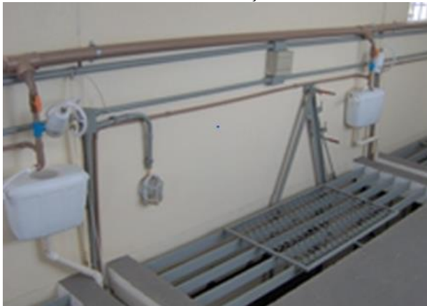
Figura 1 – Infraestrutura de instalações sanitárias e hidráulicas aéreas
