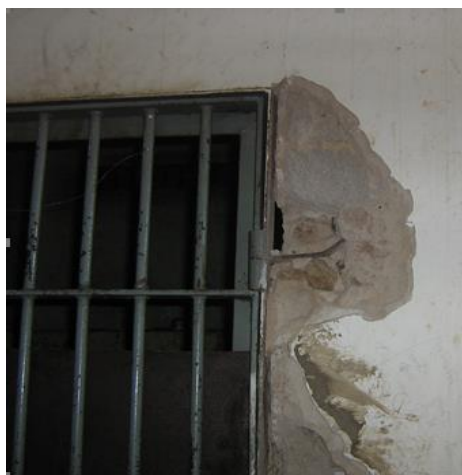
Figura 3 - Grades da UPSL-4 avariadas
