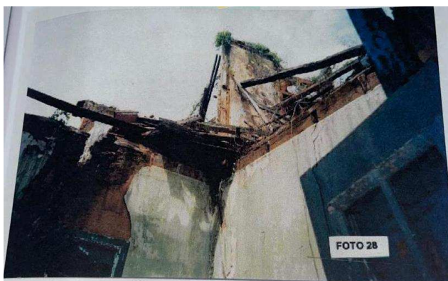
Figura 53: Mirante desabado sobre o primeiro pavimento.
