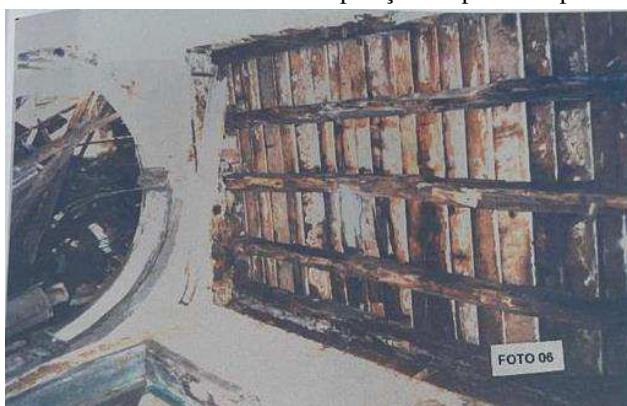
Figura 54: Assoalho do Hall de entrada deteriorado com exposição do primeiro pavimento.
