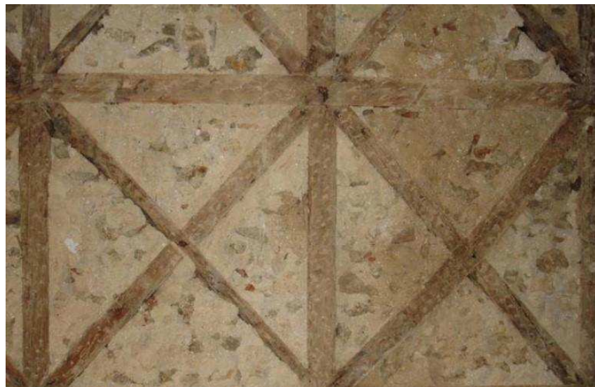
Figura 9: Gaiola Pombalina/Cruz de Santo André preenchido com argamassa de cal em São Luís.
