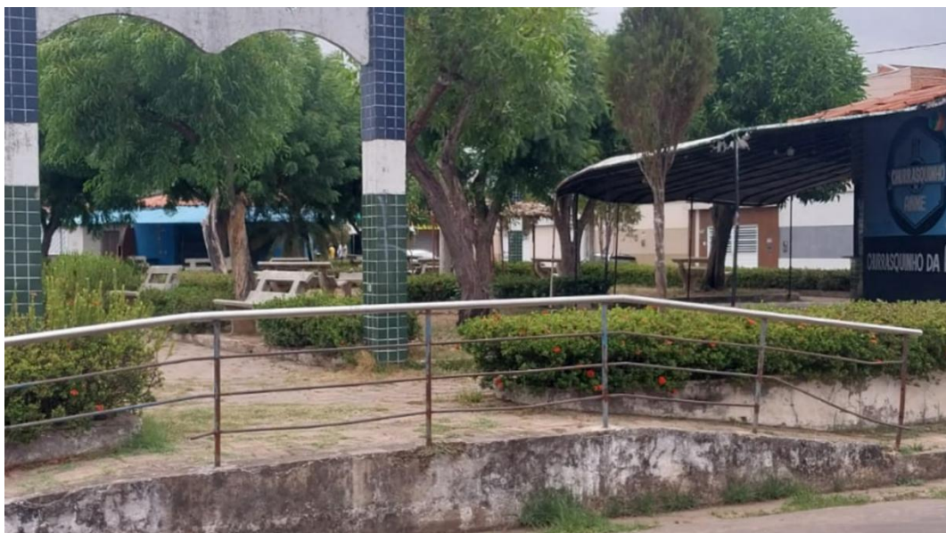
Figura 27 - Rampa sem guia de balizamento
