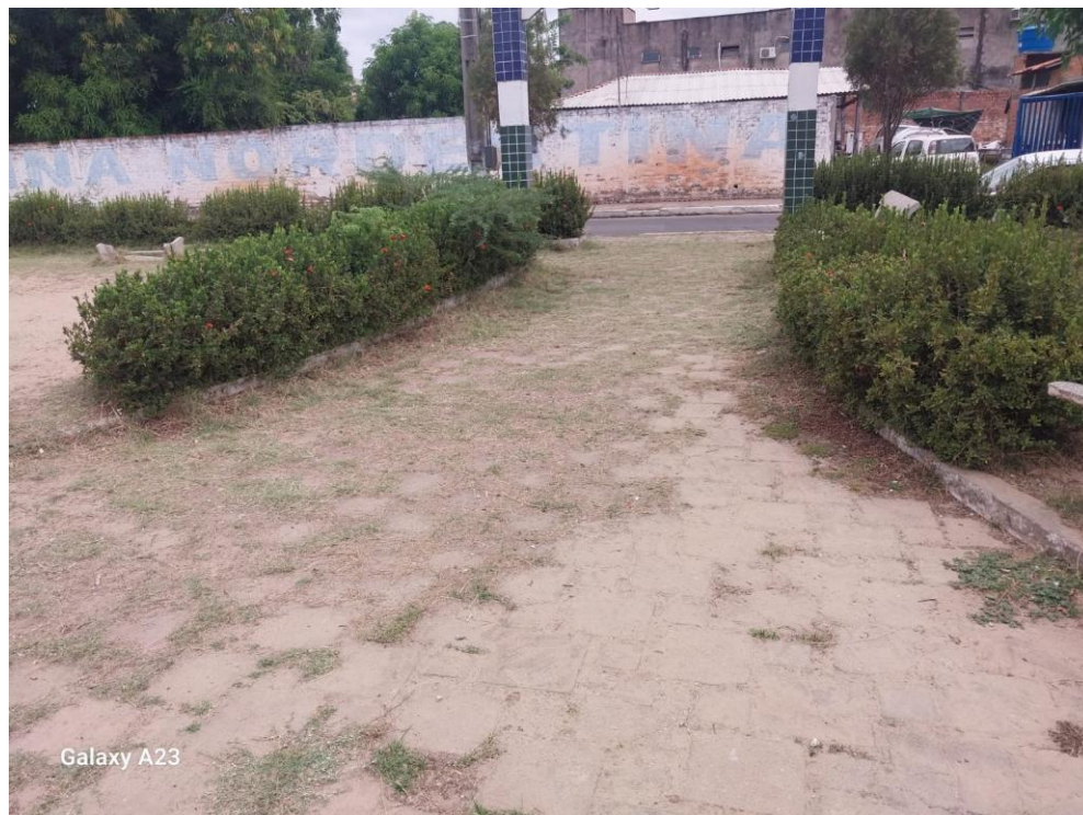
Figura 15 - Bloquetes de concreto intertravado com vegetação crescendo entre as juntas
