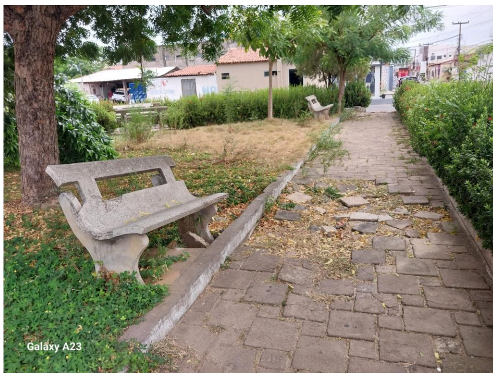
Figura 16 - Bloquetes de concreto intertravado soltos
