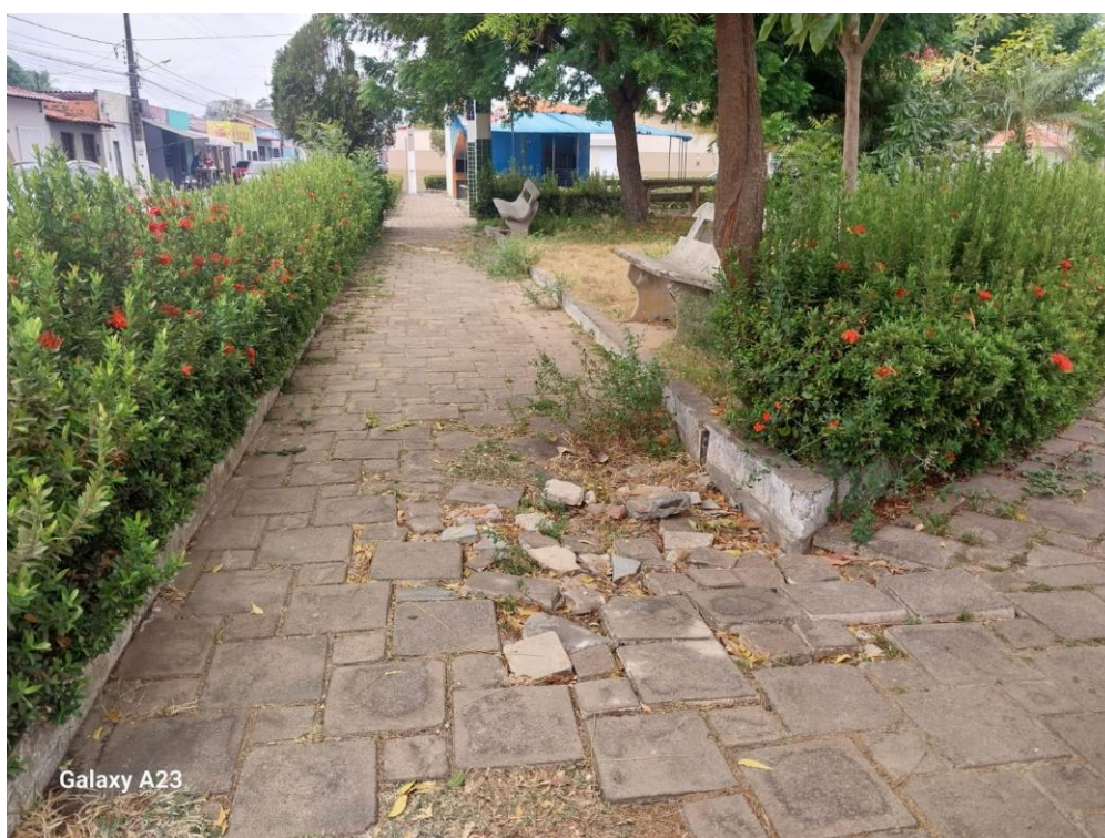
Figura 14 - Bloquetes de concreto intertravado soltos
