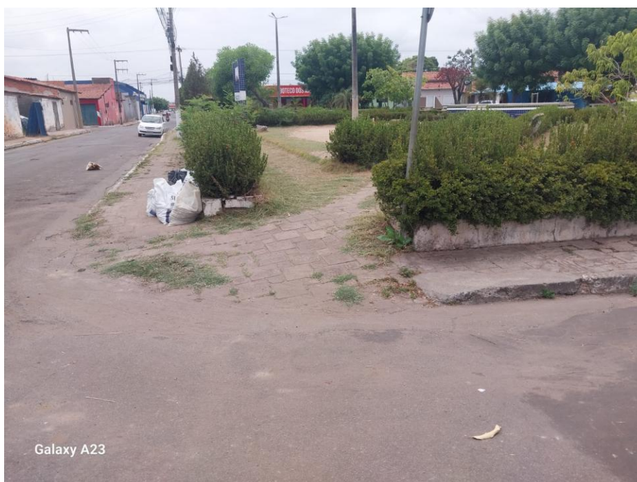
Figura 8 - Rebaixamento Inadequado de Calçada
