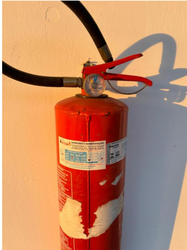
Figura 20 - Unidade extintora com rotulo rasgado
