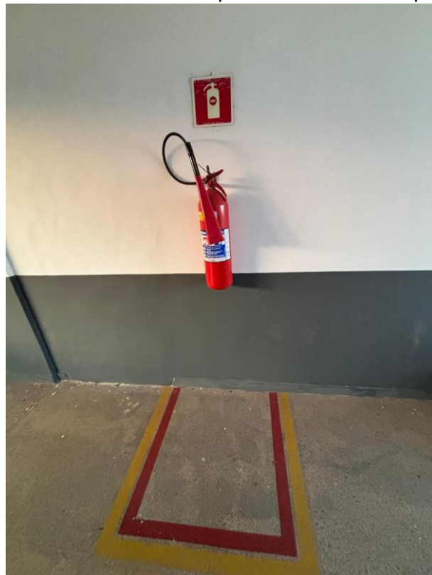
Figura 23 - Unidade extintora do campus sinalizada adequadamente
