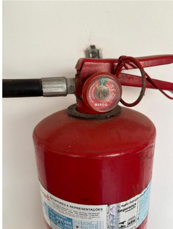
Figura 19 - Unidade extintora despressurizada
