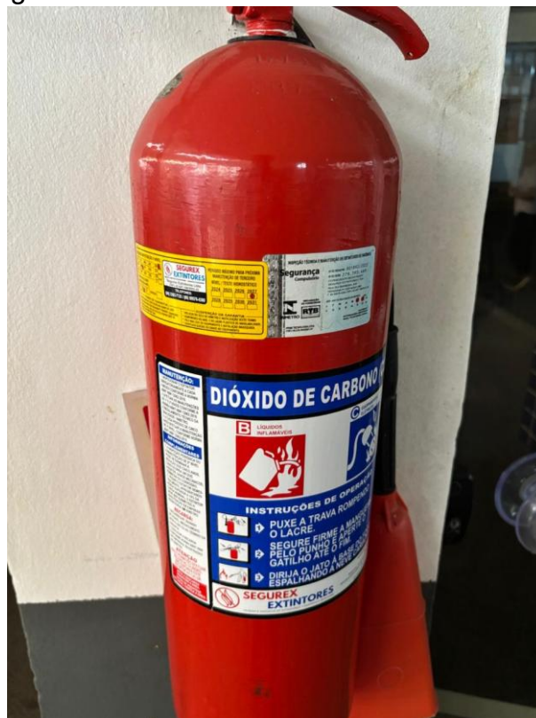
Figura 16 - Extintor de incêndio de CO 2
