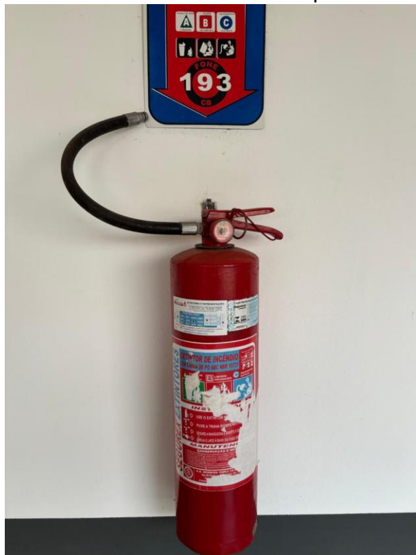
Figura 18 - Extintor de incêndio de pó ABC
