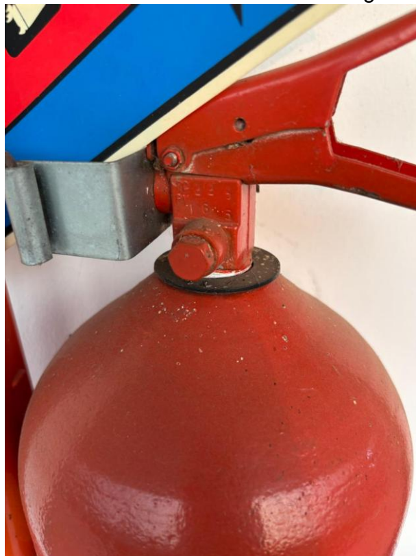
Figura 21 - Unidade extintora sem lacre de segurança
