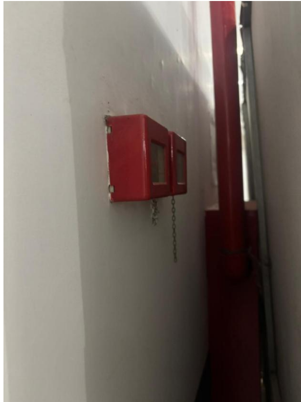
Figura 9 - Acionador do alarme de incêndio da UEMA, biblioteca.
