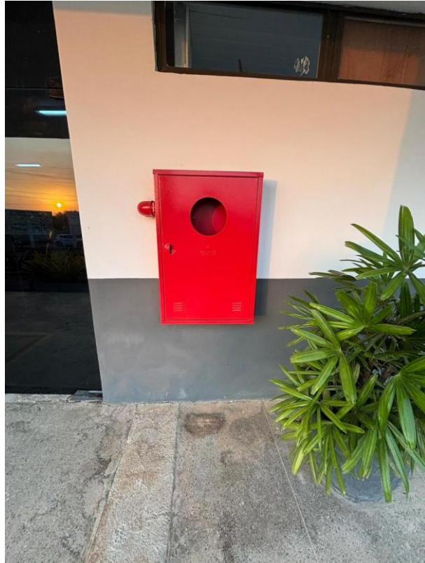
Figura 25 - Sistema de hidrantes sem a sinalização
