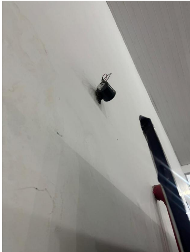
Figura 8 - Alarme de incêndio da UEMA, biblioteca
