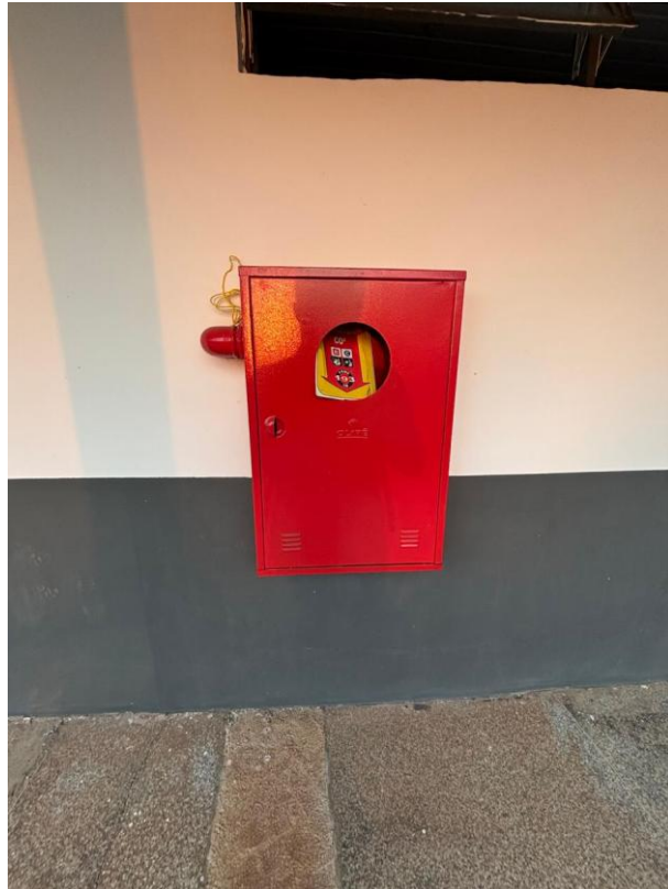
Figura 26 - Sistema de hidrantes sem a sinalização
