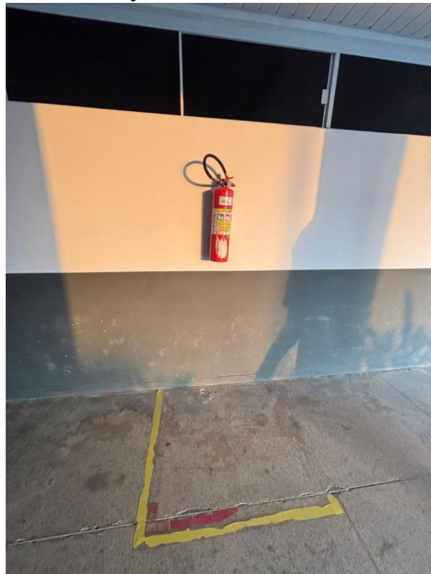
Figura 24 - Demarcação de área de extintor rasurada
