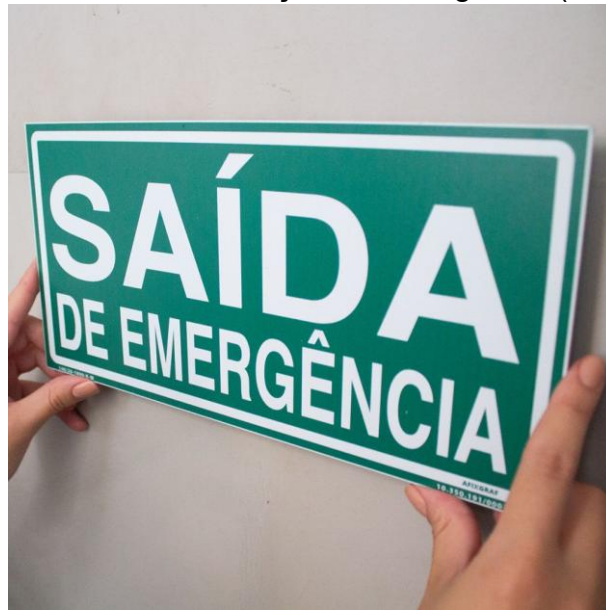
Figura 12 - Placa de sinalização de emergência (saída)
