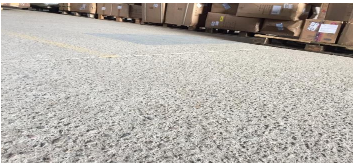
Figura 7 - Desgaste Superficial Do Concreto
