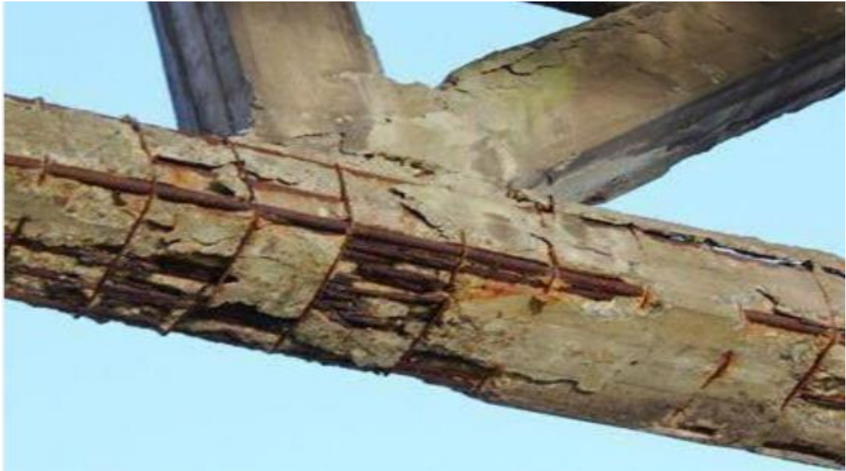
Figura 1 - Armadura de concreto exposta
