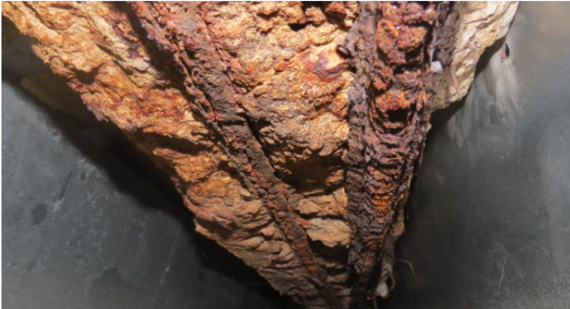
Figura 5 - Patologia de corrosão da armadura
