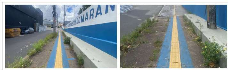
Figura 16 - Piso da calçada na Travessa Bequimão
