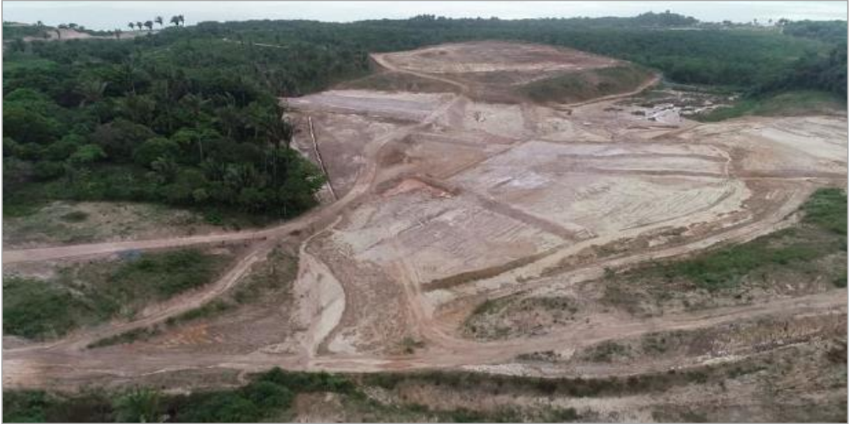
Figura 6 – Cajueiro, São Luís-MA: área desmatada em Parnauaçu por obras do TUP Porto São Luís
