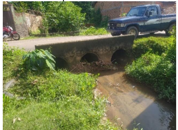
Figura 8: Bueiro tubular obstruído por sedimentos no ponto 06
