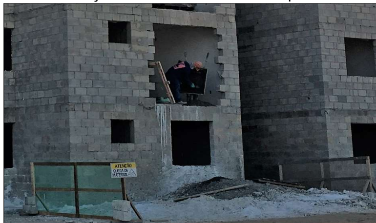
Figura 6 - Sinalização e Isolamento do local de queda de materiais
