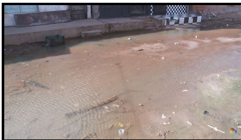
Figura 24: Vista de Rua do Bairro Barreto que sofre com problemas de alagamento.
