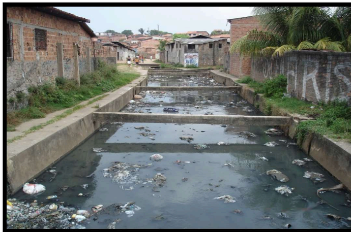
Figura 5: Vista do Canal do Coroado com depósito de resíduos sólidos na sua calha
