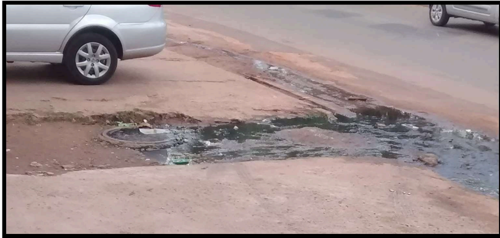
Figura 39: Esgoto ocasionado na via por falta de desobstrução ou limpeza pública de sistema de esgotamento sanitário na Av. dos Franceses, em São Luís – MA.
