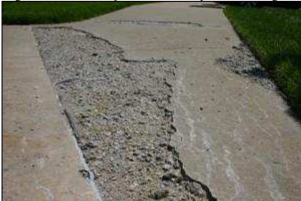
Figura 4 – Deterioração do concreto por ciclos de gelo-degelo.
