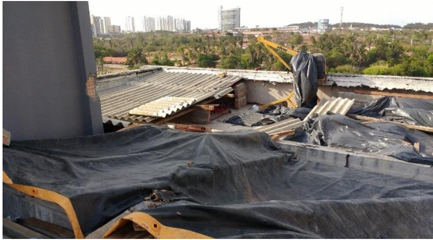
Figura 33 – Parte da cobertura coberta com uma lona para evitar infiltrações.
