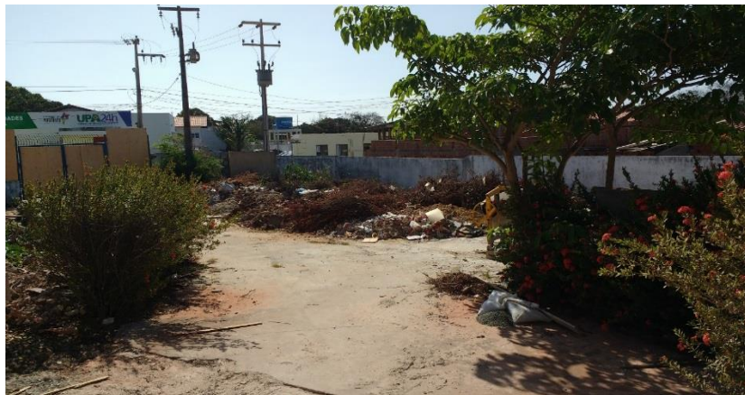
Figura 23 – Disposição dos resíduos da reforma próximo ao portão de saída aguardando a empresa de coleta e transporte.
