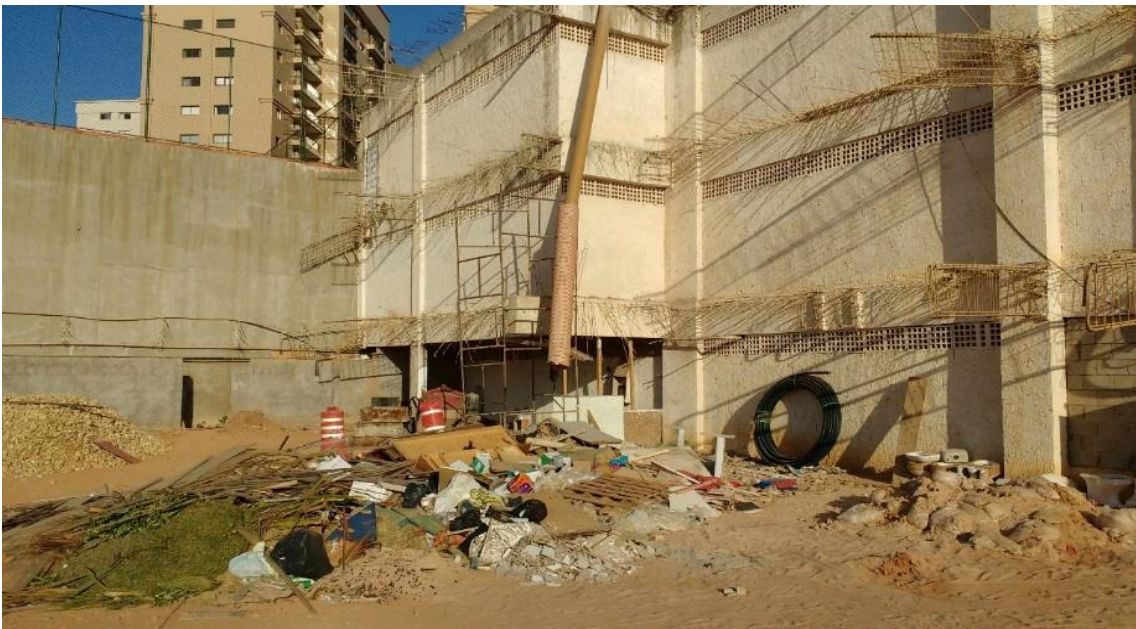
Figura 12 – Resíduos de diferentes classes misturados em obra visitada
