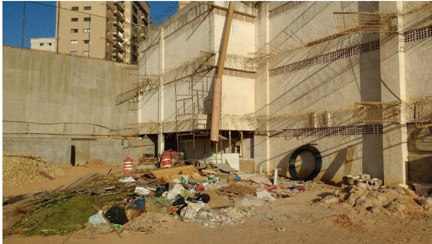
Figura 27 – Disposição dos resíduos da obra sem segregação.
