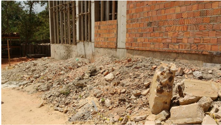
Figura 19 – Resíduos dispostos de forma equivocada ao lado do primeiro anexo.
