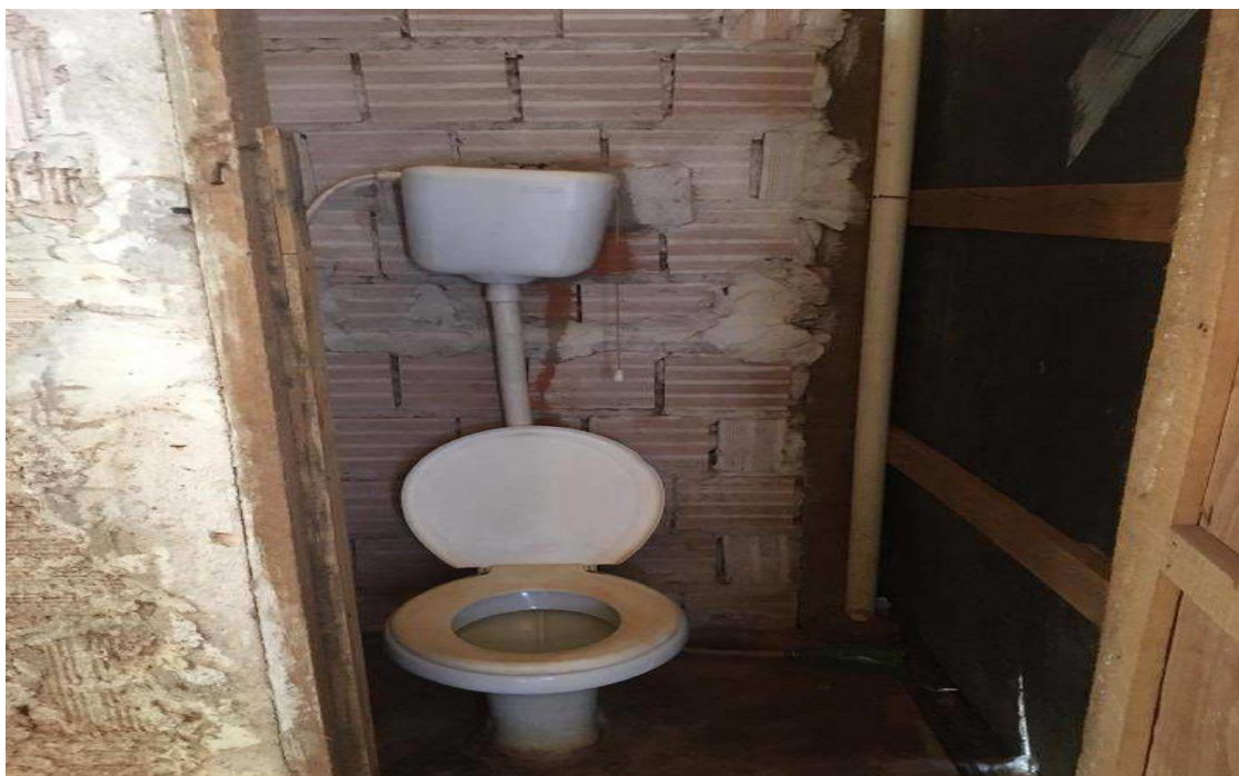
Figura 8- Sanitário do Canteiro de Obra A
