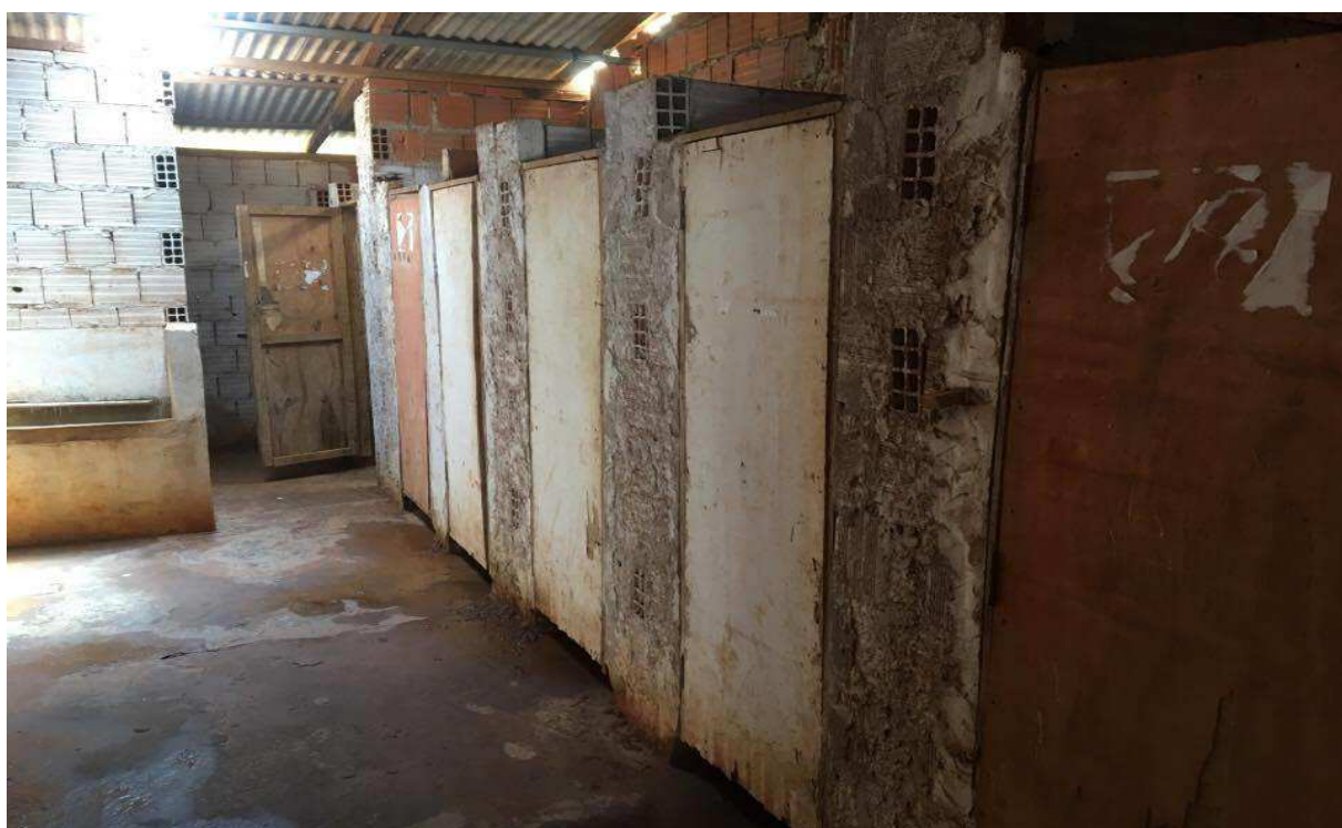
Figura 6 – Sanitário do Canteiro de Obra A
