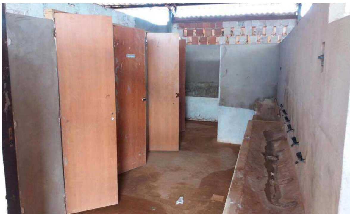
Figura 16 – Sanitários do Canteiro de Obra B
