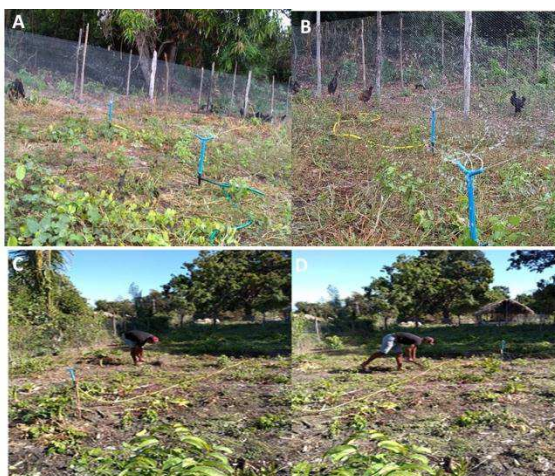
Figura 14 - A, B, C e D Instalação dos kits de irrigação montado nas duas áreas de pastagem.
