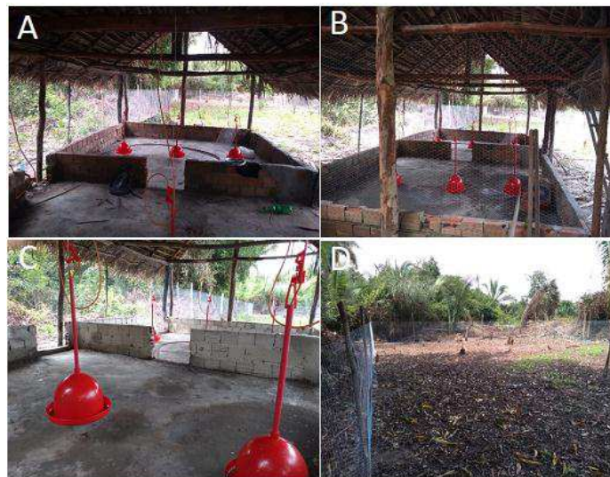
Figura 7 - A, B, C Montagem e teste de vazamento de bebedouros e D Finalização da área 2 de pastagem.
