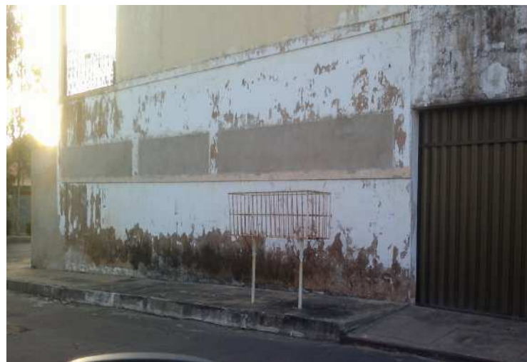
Figura 26 - Calçada na Rua 11.
