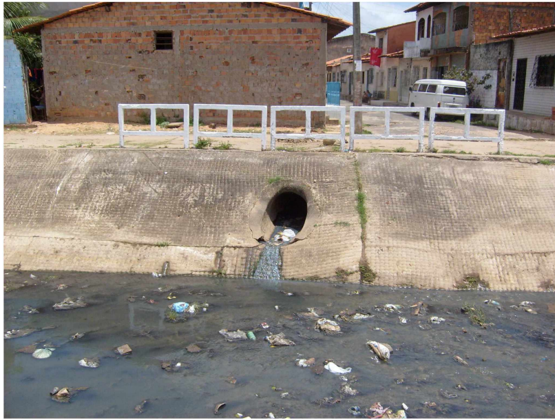
Figura 29: Acúmulo de lixo jogado no canal Fonte: Edelcy Araujo, Novembro 2007
