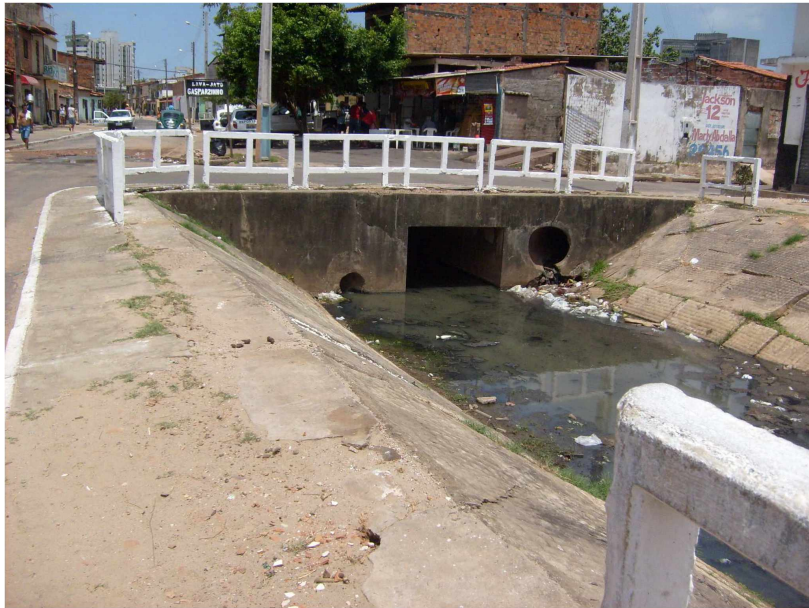
Figura 27: Vista do canal sem mureta de proteção Fonte: Edelcy Araujo, Novembro 2007
