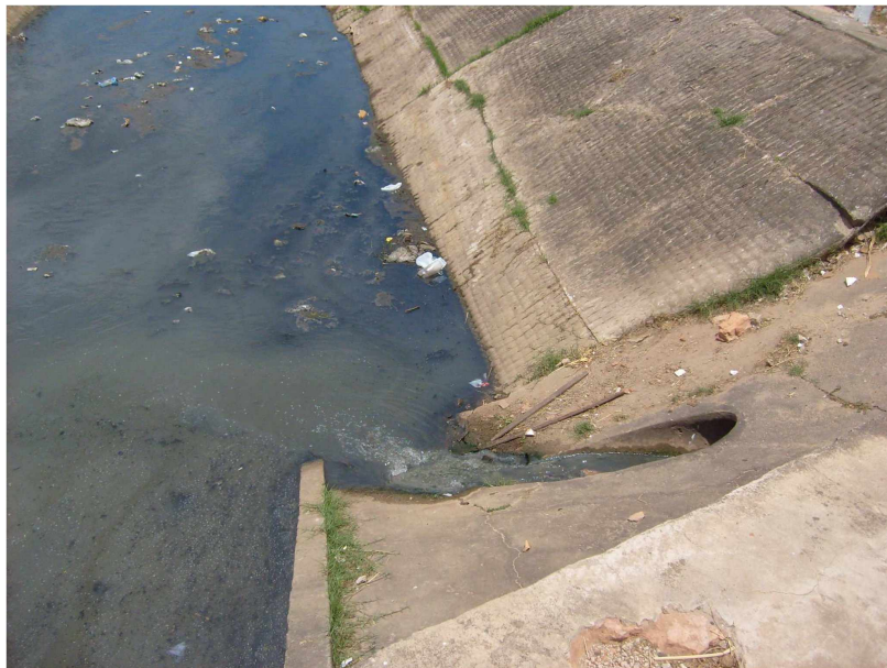
Figura 30: Tubulação de esgoto, despejo direto no canal. Fonte: Edelcy Araujo, Novembro 2007
