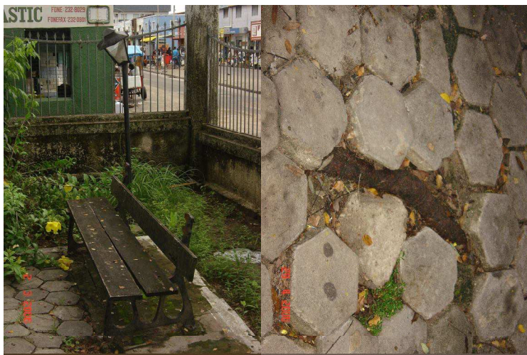
Figura 14 - Pavimentação e equipamentos danificados Fonte: a autora
