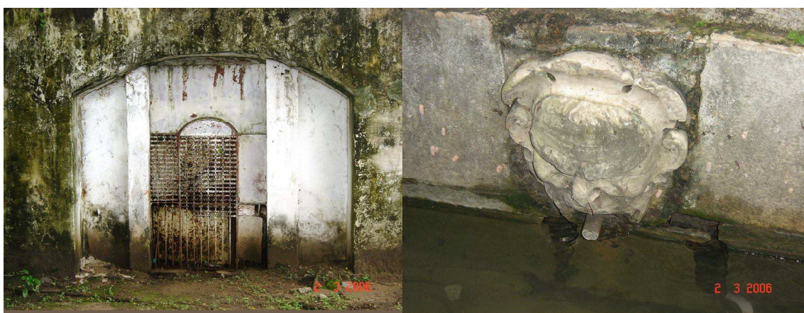
Figura 11 - Portão e Carranca obstruída Fonte: A autora
