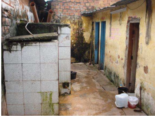
Figura 57: Banheiros antes da reforma Fonte: SEMOSP
