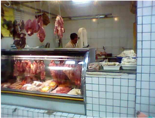
Figura 12: equipamento de refrigeração Fonte: própria, 2010
