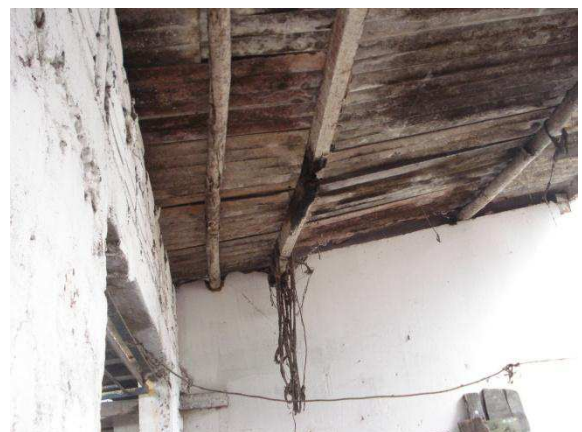
Figura 65: Fiação exposta e teia de aranha
