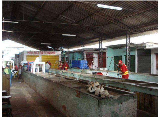
Figura 55: Bancas sem revestimento Fonte: SEMOSP
