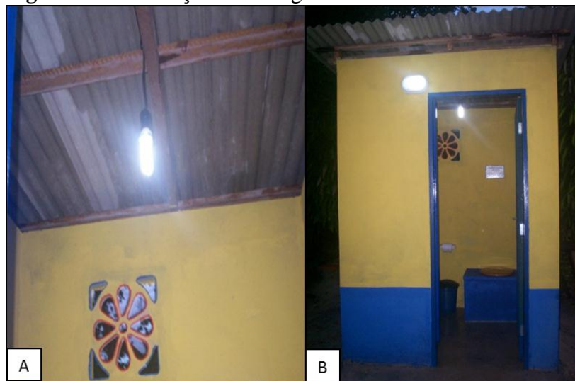
Figura 29. Iluminação dos abrigos.
