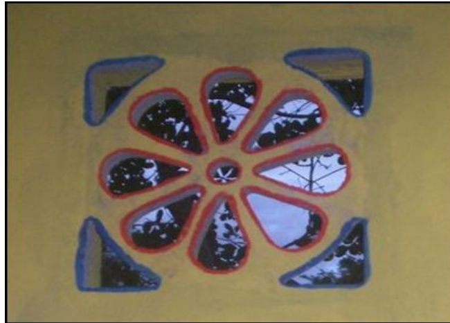
Figura 28. Ventilação dos banheiros.
