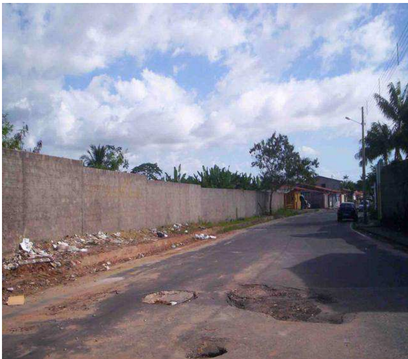
Figura 39 – Péssimo estado das ruas e o lixo compo ndo o espaço urbano do bairro. Fonte: SARAIVA, 2008.
