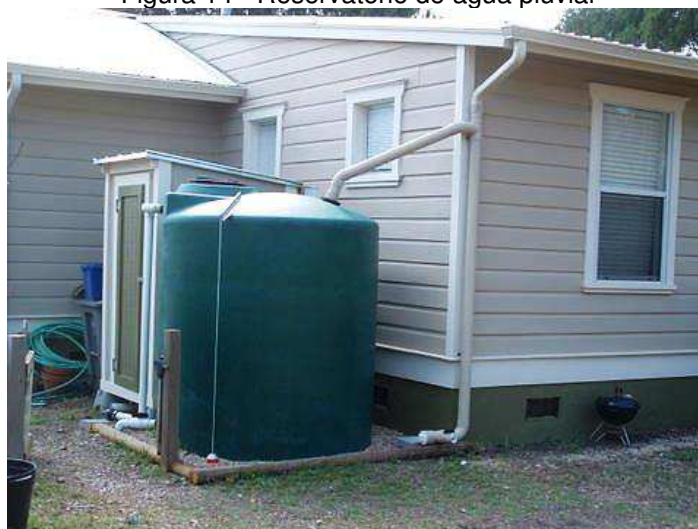
Figura 14 - Reservatório de água pluvial
