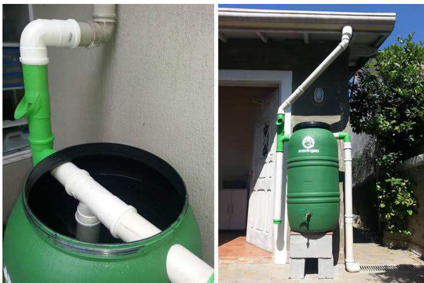
Figura 42 - Exemplo de reservatório
