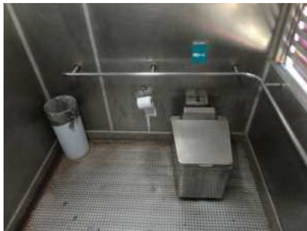
Figura 28 – Banheiro adaptado do carro P.C.D
