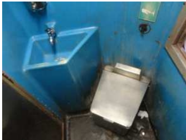
Figura 25 – Banheiro dos vagões executivos
