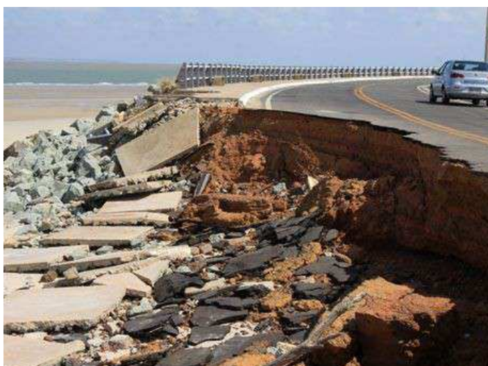
Figura 31 – Erosão na via de contorno da Ponta D'areia. Fonte: Acesso Maranhão. 2011
