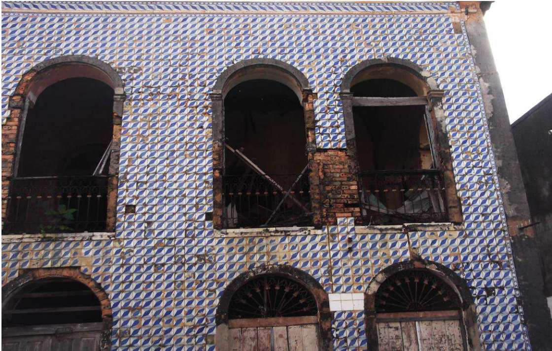
Fig. 49 Fachada azulejada em processo de deterioração
