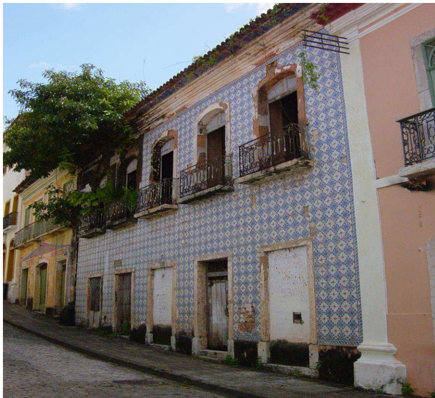
Fig. 11 Vegetação na fachada - Rua do Giz, 53 Fonte: Inventário do Patrimônio Azulejar do Maranhão, 2012
