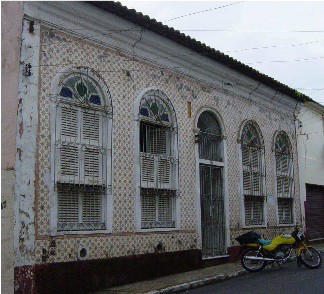
Fig. 13 Fachada com fungos - Rua das Hortas, 277 Fonte: Inventário do Patrimônio Azulejar do Maranhão, 2012
