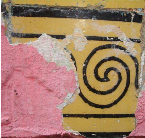
Fig. 58 Cercadura da fachada pintada com tinta Fonte : Inventário do Patrimônio Azulejar do Maranhão, 2012.
