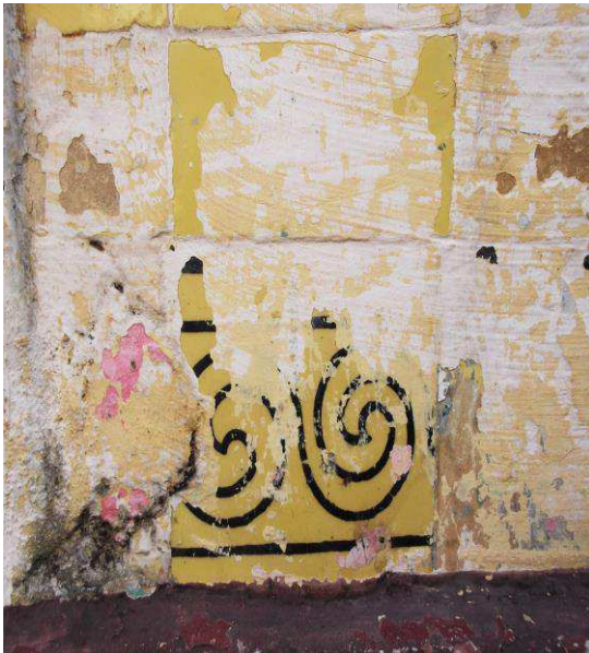
Fig. 60 Cercadura da fachada pintada com tinta Fonte : Autora, 2013.
