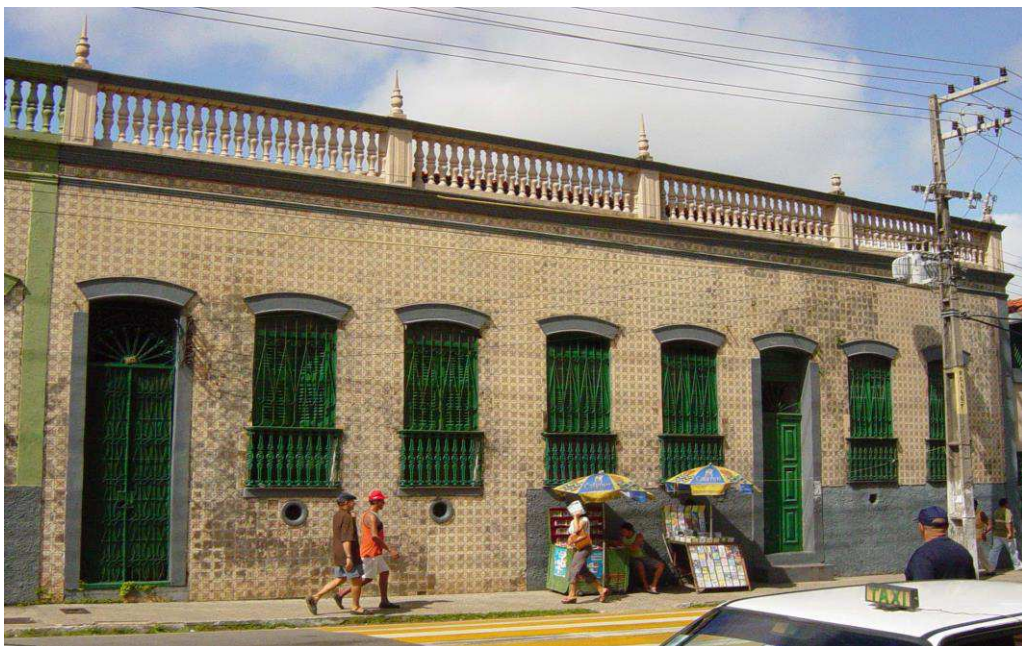
Fig. 22 Rua Grande, 1032 - Fachada com azulejos de decalque contaminados por fungos Fonte: Inventário do Patrimônio Azulejar do Maranhão, 2012.
