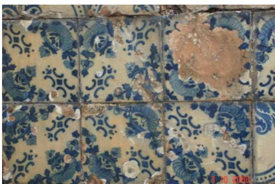
Figura 28 – Azulejos com perda de vidro. Fonte: Superintendência de Patrimônio Cultural, (Secma), 2008.
