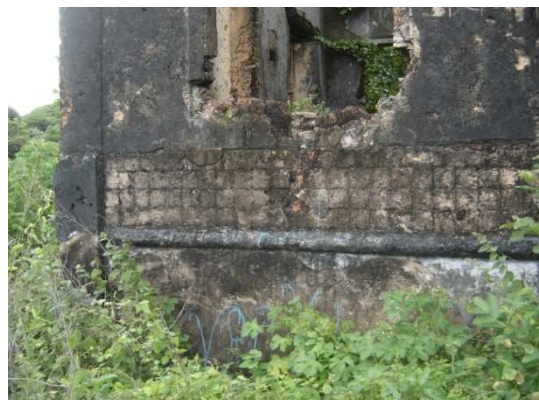
Figura 14 – Parte da fachada, vendo-se barra onde existiam azulejos. Fonte: LIMA, 2012.
