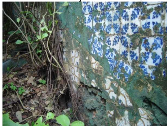
Figura 16 – Parede da escada e azulejos. Fonte: LIMA, 2012.
