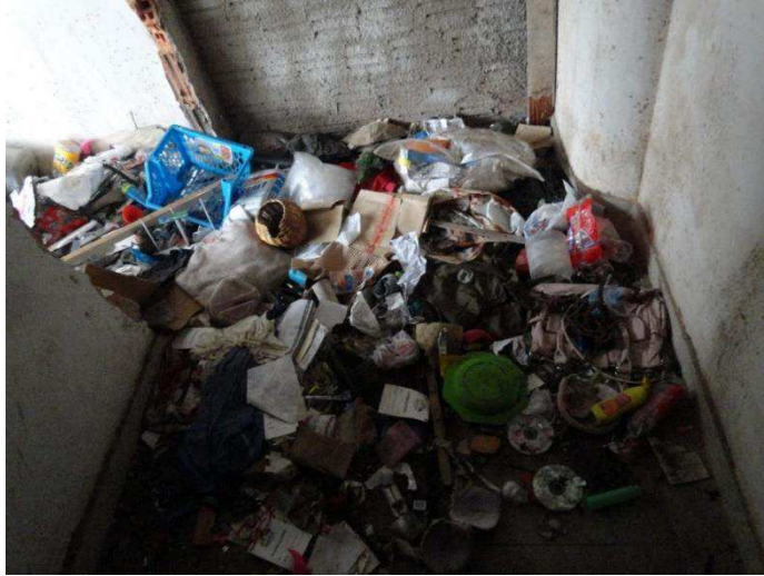
Figura 53 – Grande acúmulo de lixo encontrado em um dos compartimentos do segundo pavimento. Fonte: BATISTA, 2017.
