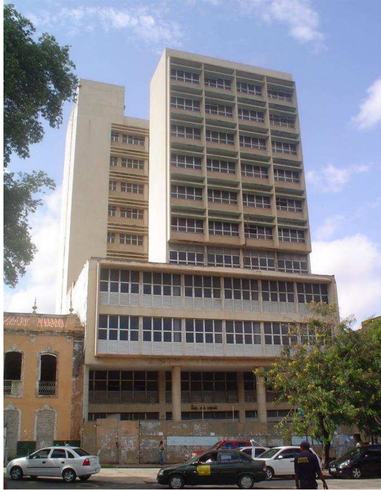
Figura 20 - Fachada frontal do edifício e seu estado de conservação há 10 anos. Fonte: FIGUEIREDO, 2006.
