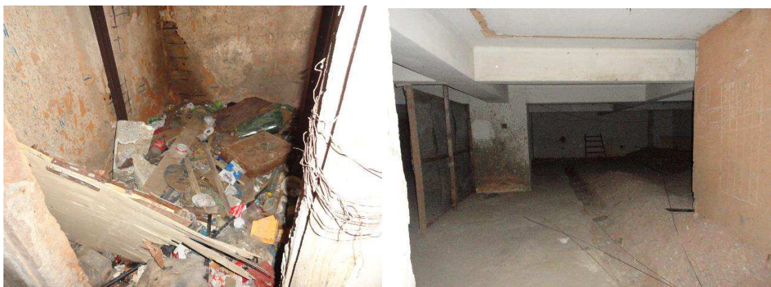
Figura 44 - Imagem do fosso do elevador ao nível do segundo subsolo. Fonte: BATISTA, 2017.
