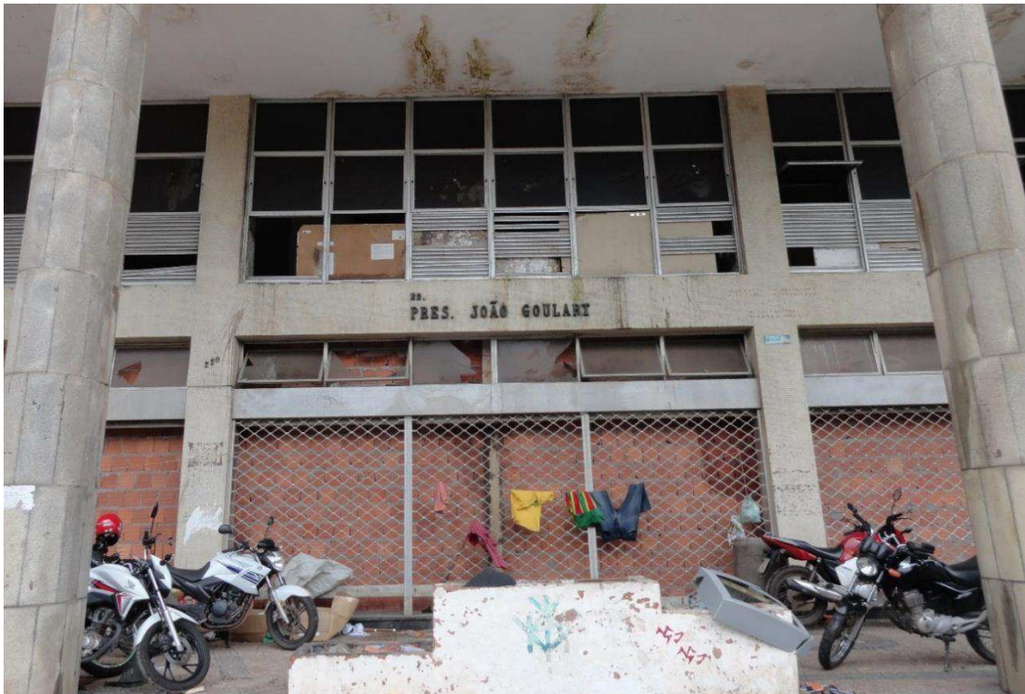
Figura 36 - Registro aproximado da fachada frontal do Ed. João Goulart, feito em março. Fonte: BATISTA, 2017.
