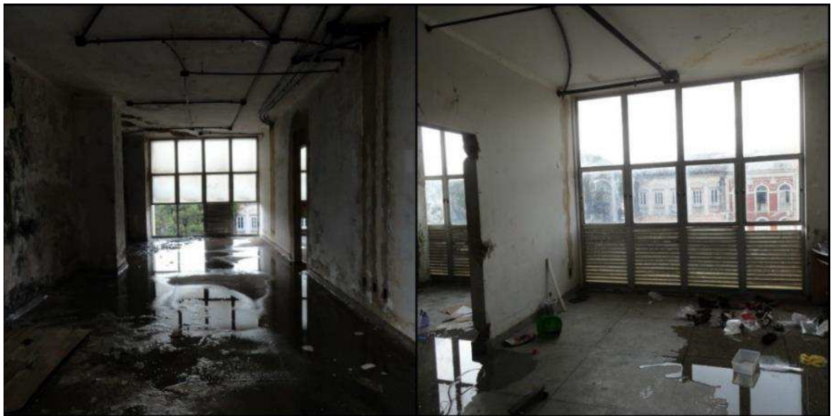
Figura 54 - Sequência de registros, de outras duas salas distintas do segundo pavimento. Fonte: BATISTA (2017).
