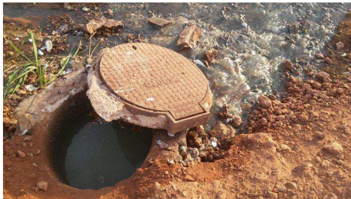
Figura 61 – Caixa de esgoto transbordando em direção ao Rio Calhau, próximo a Av. Santo Antônio, no Calhau.
