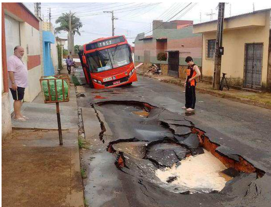
Figura 30. Asfalto cede após chuva em São Luís – Ma
