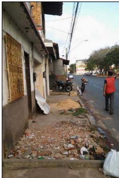
Figura 18 - Calçada quebrada por falta de manutenção
