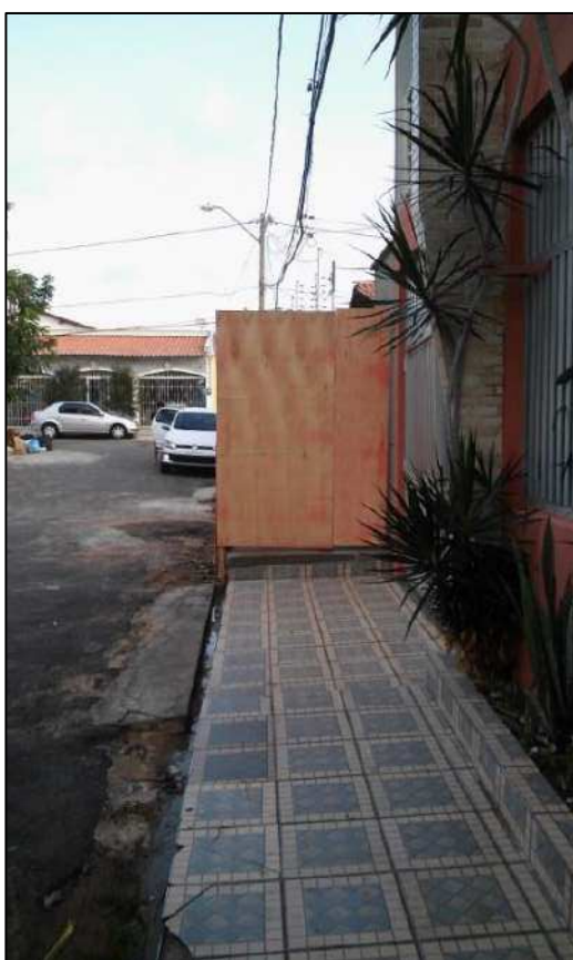
Figura 12 - Tapume de construção obstruindo toda a calçada.
