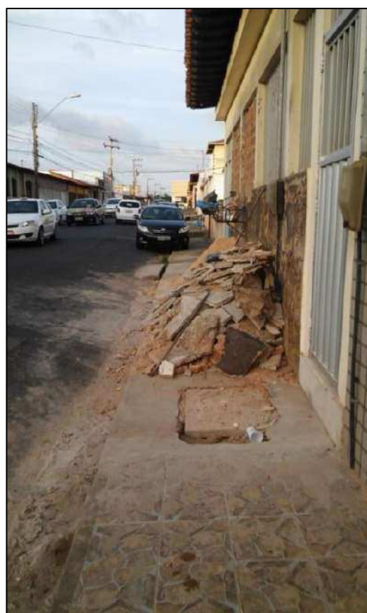
Figura 13 - Entulhos de obra bloqueando completamente a calçada.
