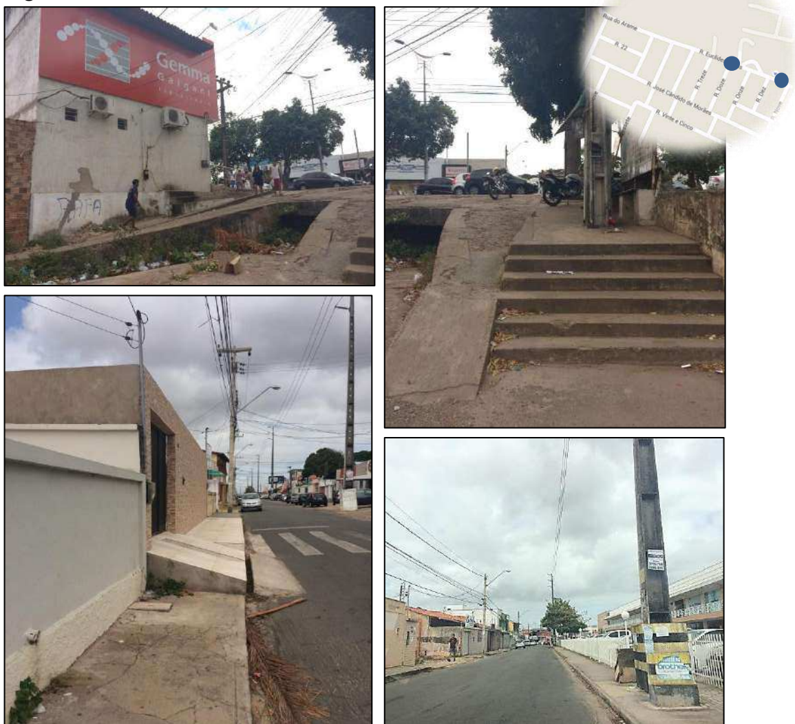
Figura 69 - Falta de acessibilidade na rua Euclides Farias
