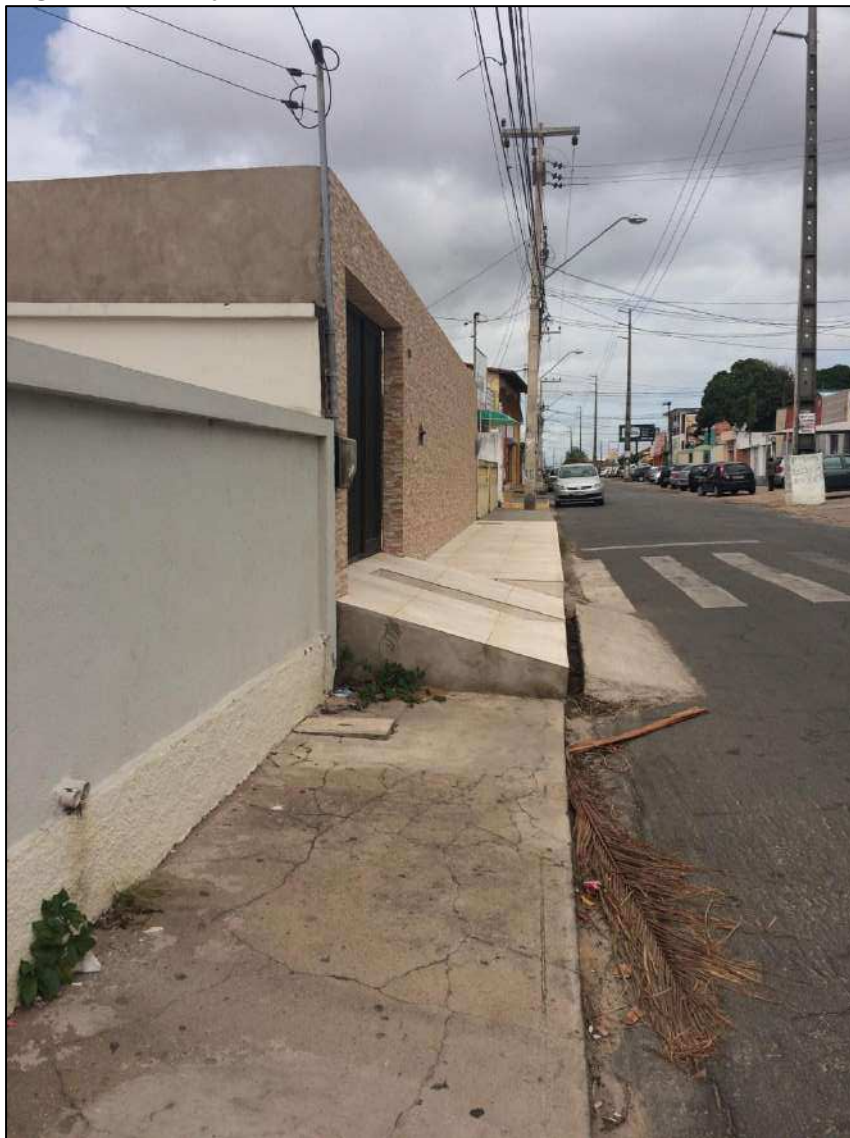
Figura 79 - Calçadas inacessíveis na rua Euclides Farias
