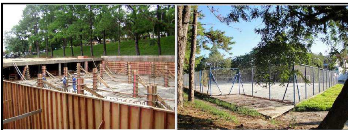
Figura 18 - Reservatório de detenção na Praça Celso Luft, Porto Alegre, RS
