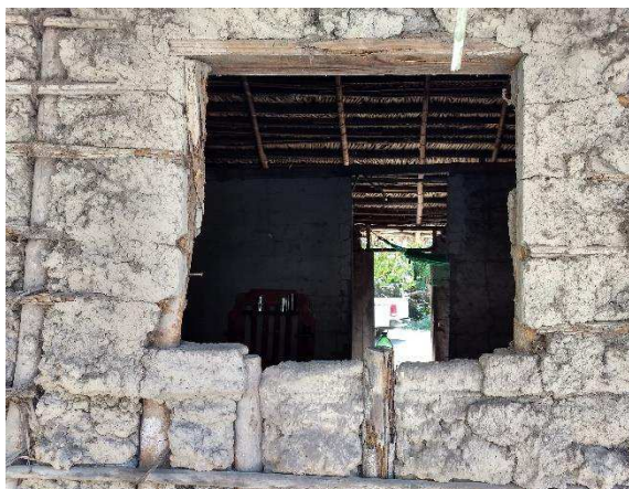
Figura 77 - Abertura sem fechamento - Casa Raimundo - Povoado Lagoa Amarela, Chapadinha/MA
