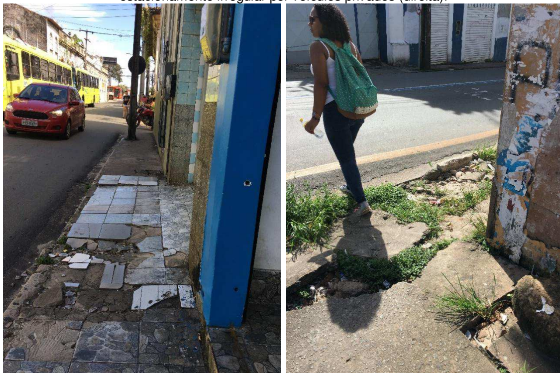
Figura 45 Calçamento irregular em estado de desagregação (esquerda). Figura 46 Calçamento de concreto danificado devido à falta de manutenção e uso indevido como estacionamento irregular por veículos privados (direita).
