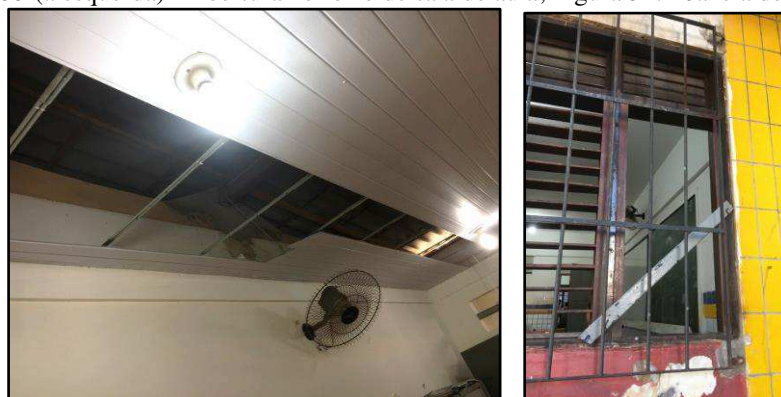
Figura 33 (à esquerda) - Abertura no forro de sala de aula; Figura 34: - Janela depredada
