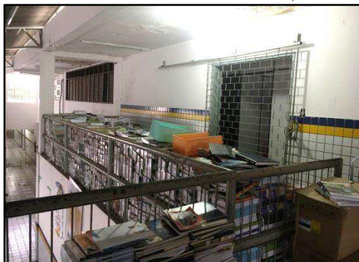
Figura 37 - Porta de acesso às salas de informática e biblioteca, e livros empilhados no mezanino
