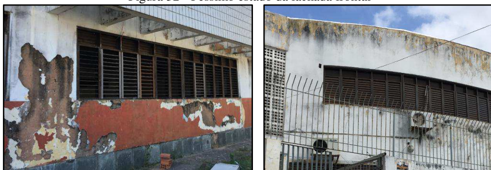
Figura 32 - Péssimo estado da fachada frontal
