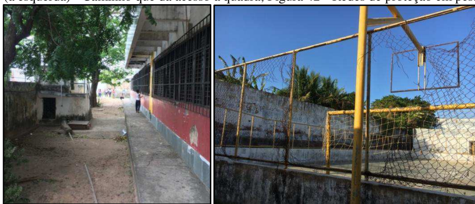
Figura 41 (à esquerda) - Caminho que dá acesso à quadra; Figura 42 - Redes de proteção em péssimo estado
