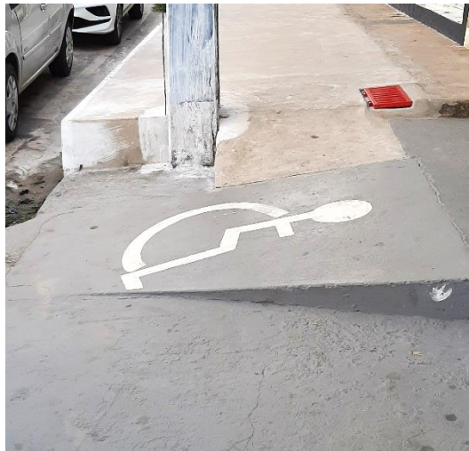
Figura 25 - Rampa invadindo a faixa de livre circulação
