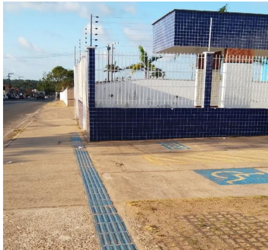
Figura 26 - Piso tátil sem continuidade em toda a calçada
