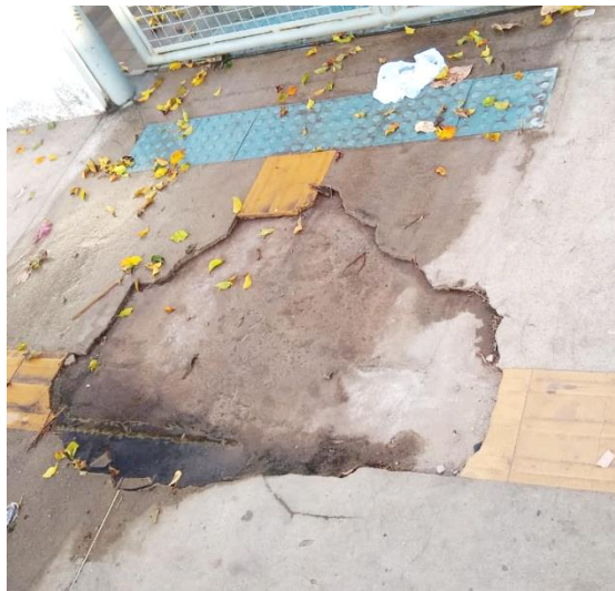
Figura 27 - Piso Tátil comprometido
