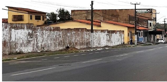
Figura 40 - Trecho com fachada inativa na Avenida 13
