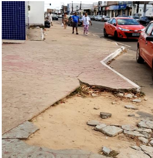
Figura 19 - Calçada com buracos
