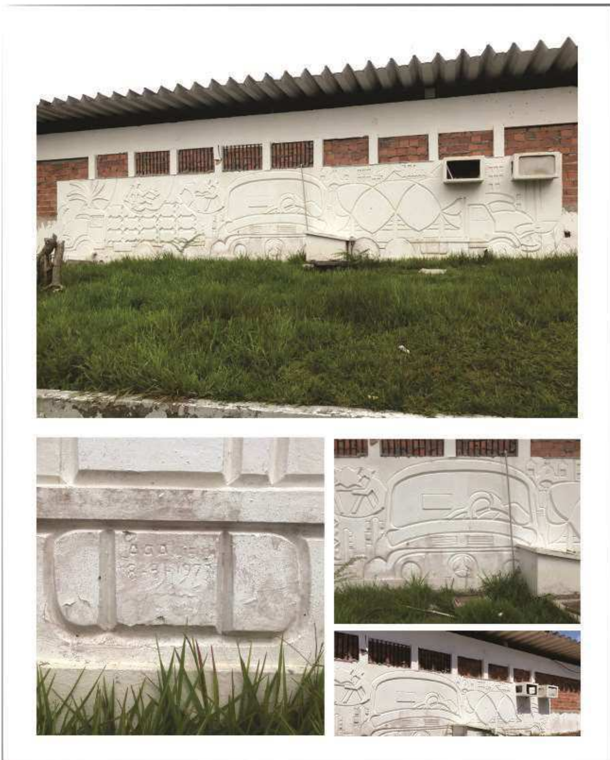
Figura 56 - Montagem do mural da antiga Mardisa em estado de abandono
