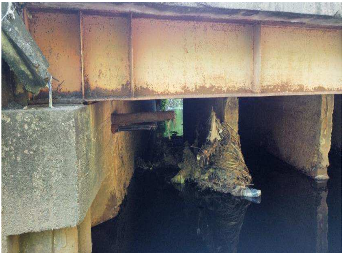
Figura 24 – Material obstruindo parcialmente fluxo da água nas estruturas da galeria celular
